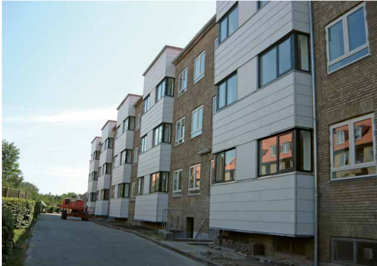
Bygningen har fået en installationskarnap, der er isoleret med 250 mm mineraluld, og som er monteret ud for eksisterende vindueshuller på gårdfacaden i den tidstypiske gule teglstensbebyggelse i Vanløse.
