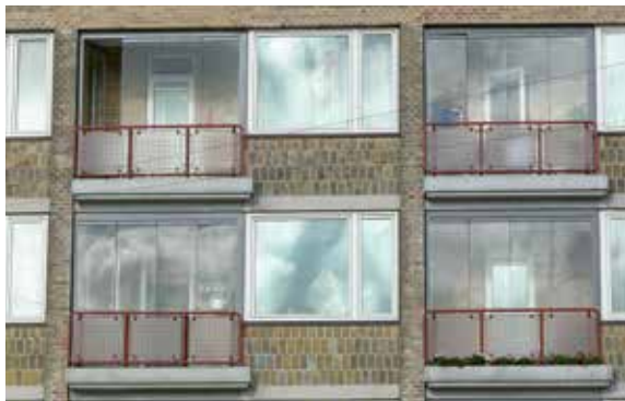
Altanerne har fået en støjrducerende glasinddækning mod larm fra de omkringliggende hovedveje.
