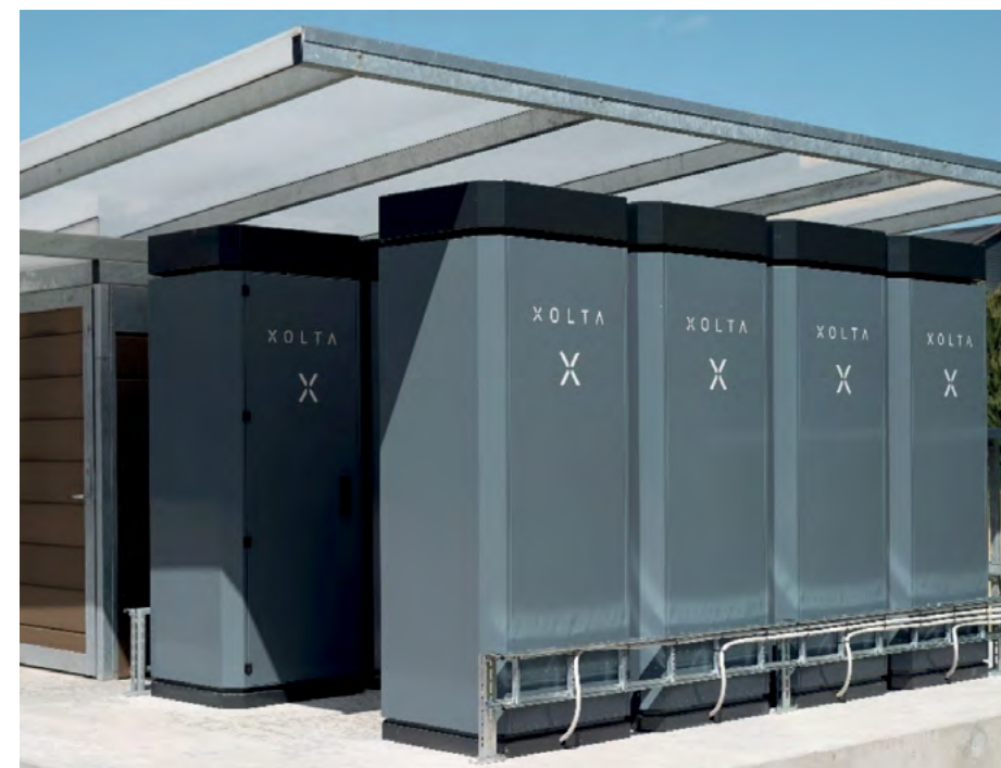
Figur 13: Haarups maskinfabrik ved Silkeborg har monteret 12 XOLTA-batterier, der lagrer el fra fabrikens solceller og gør fabrikken selvforsynende med elektricitet fra marts til november [53].
