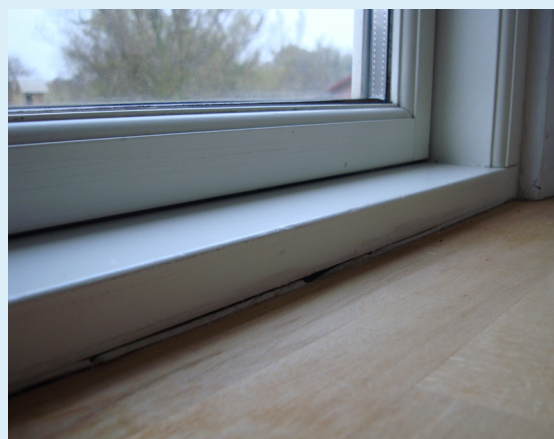
Utæt fuge under vindue.
