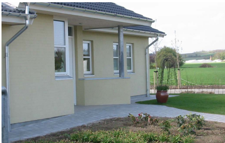
Figur 17. Fritliggende enfamiliehus udført med 150 mm fri sokkelhøjde og lokalt hævet terræn ved indgang, som er overdækket. Sundt princip, dog mangler rende mellem hævet terræn og sokkel. Mårslet.
