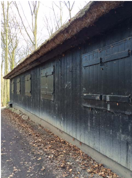
Figur 75. Eksempel på træfacade med jordpartikler fra opsprøjt op til 5-700 mm højde. Nordvendt facade. Belægning af jord. Der er ingen tagrende..
