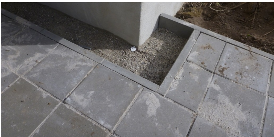
Figur 20. Render bør have afløb ud over terræn med jævne mellemrum, fx i enderne. Lukkede render, der kun afvander gennem dræn har ofte været anvendt, men de er ikke i overensstemmelse med Drænnormen. I dette tilfælde er det ret enkelt at åbne enden af renderen, så vandet kan afledes over terræn. Nyborg.
