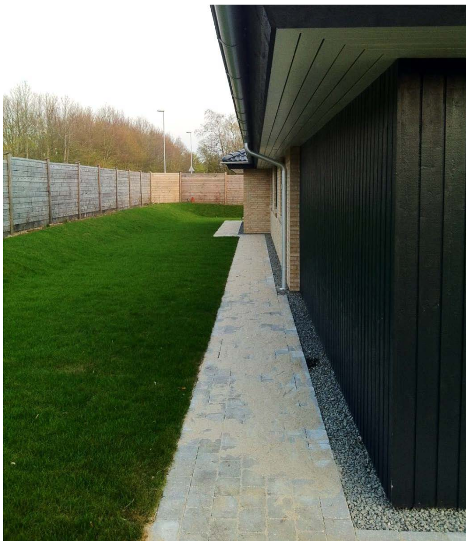
Figur 21. Eksempel hvor fald væk fra ny bygning er svagt, og hvor renden er meget lille (ca. 50 mm dyb) og desuden ikke har afløb. Renden er desuden fyldt helt op med granitskærver, så der ikke er fri sokkelhøjde på 150 mm.
