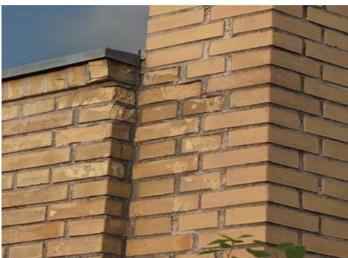
Foto 34 Frostsprængt murværk med fare for indtrængen af fugt. Stenhøjgaardsvej
