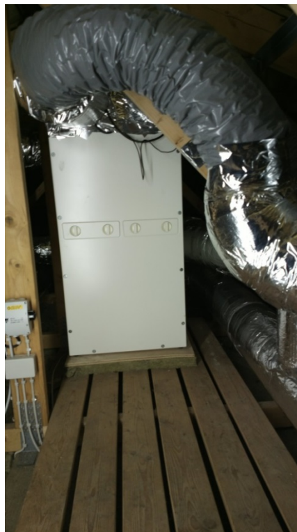
Foto 25 Nyt ventilationssystem med varmegenvinding på loftet. Græsvangen
