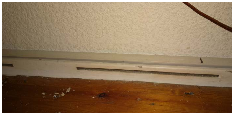
Foto 10 Ofte har der i årene før den omfangsrige renovering været taget adskillige initiativer af forskellig art for at komme skimmel og mug problemer til livs - her er der for år tilbage etableret udluftningsslidse i fodpanelerne - dog uden nævneværdig effekt. Munkebjergparken, Odense
