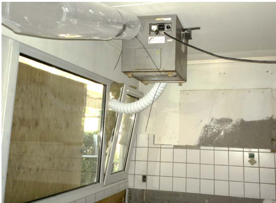
Foto 3 Tørring af og affugtning i hus med skimmel som er underrenovering. Græsvangen, Aarhus
