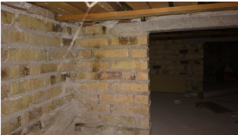
Foto 33 Krybekældrene under den del af bebyggelsen som er i ét plan og som har været en medvirkende årsag til skimmelp problemer. Stenhøjgaardsvej
