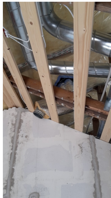
Foto 42 Etablering af nyt loft med ventilation. Peter Hansensvej, Fåborg. Foto: Turid Øien
