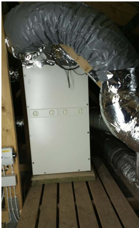
Foto 12 Nyt lokalt ventilationsanlæg med varmegenindvinding på loftet af rækkehus. Græsvangen Århus
