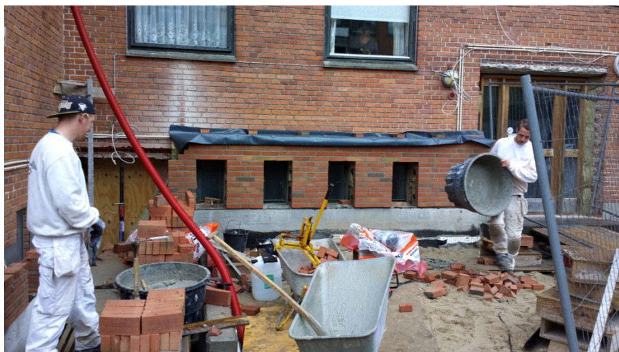
Foto 8 Det kan være svært at sikre adgangsveje til opgangene når der samtidig arbejdes på pladsen (Jyllandsgade, Randers)
