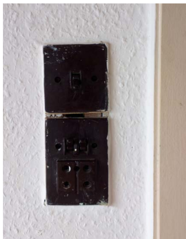
Foto 45 El installationer skiftes ikke selv om det er en omfattende renovering. Kapellanvej, Holbæk
