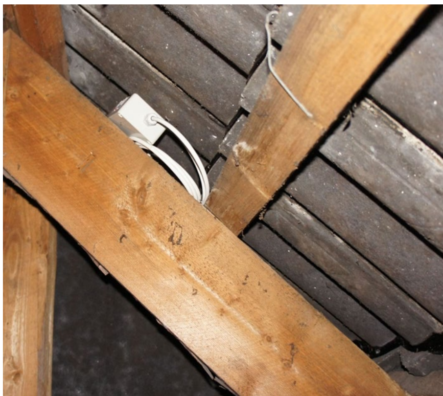
Figur 84. Føler placeret i tag under tagrygning.
