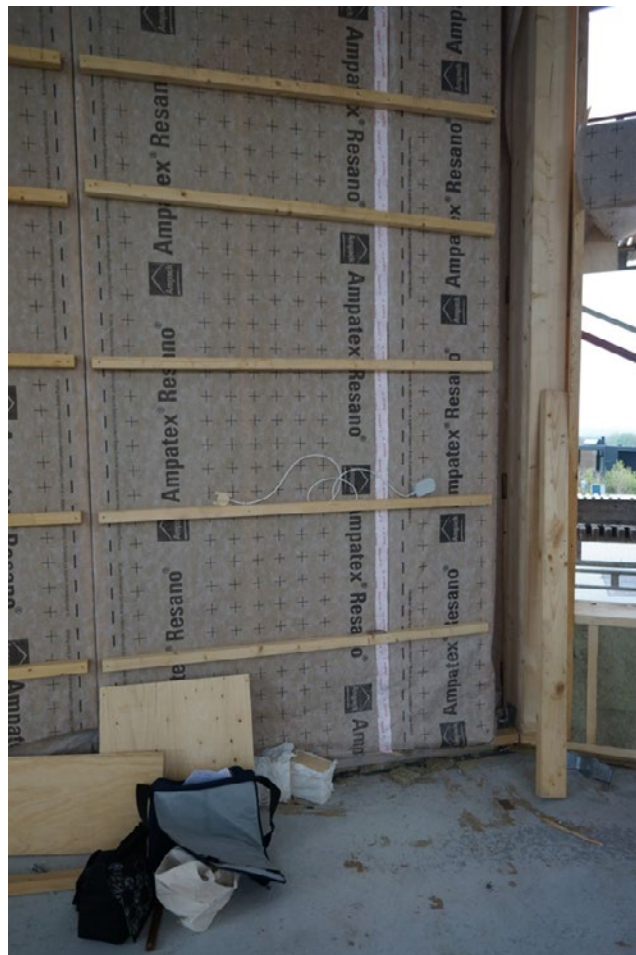
Figur 110. Foto af væg indefra – føler ses placeret i inderste isoleringslag.
