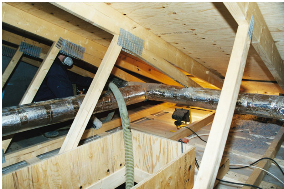
Figur 25. Udsnit af det ventilerede loftsrums. Fædeslangen, som bringer isoleringsmateriale frem, føres op til loftsrumsrummet gennem loftslommen.
