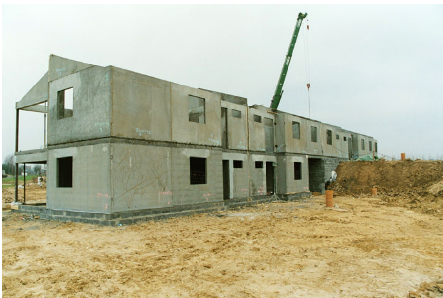
Figur 1. Opsætning af letklinkerbetonvægelementer, i det første længehus, på fundamenter støbt på stedet.
