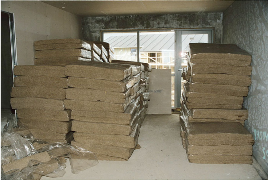
Figur 27. Hørmåtter leveredes emballeret parvis i plast. Til denne isoleringsopgave blev der anvendt isoleringsmåtter med en tykkelse på 100 mm.
