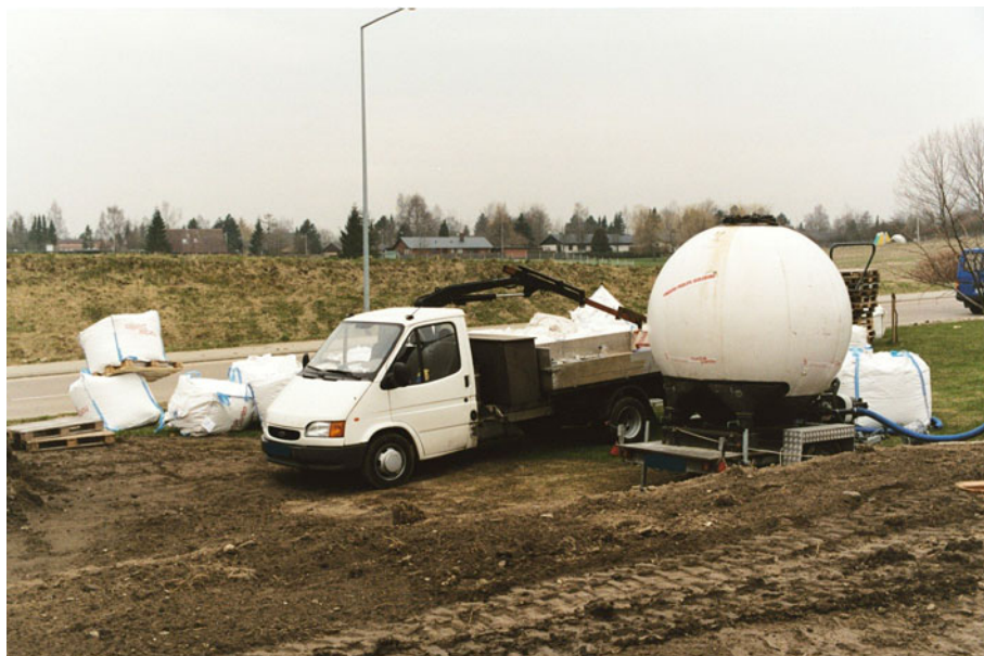
Figur 35. Perlite leveres i sække, som med kran fyldes i en trykbeholder. Ved hjælp af beholderen pumpes Perlite frem til udlægningsstedet via slanger.
