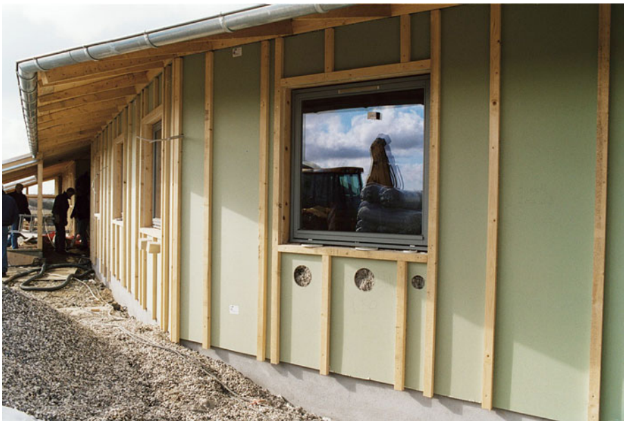
Figur 24. Isolerede hulrum under et vindue.
