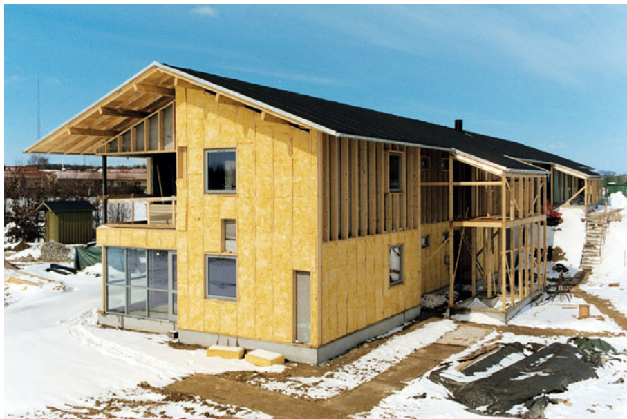
Figur 10. Huset er lukket med vinduer og døre. Gavle og underetage isoleres med Isover mineraluld.
