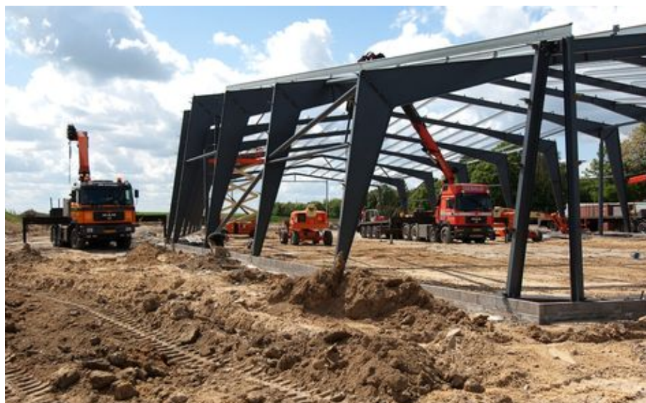
Figur 14. Opsætning i 2009 af stålbuer til de to haller på byggeriet Hulehøjgård, Veksø.
