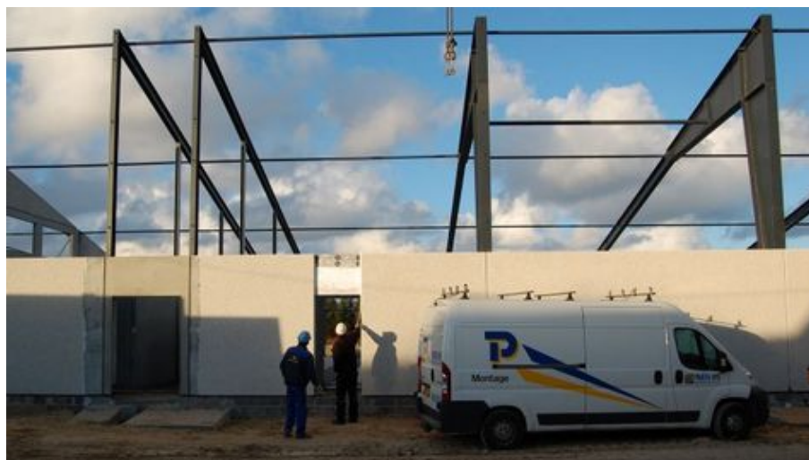
Figur 17. Stålbuerne blev rejst i 2008 til de nye svinestalde på byggesagen Sønderskovgård, Hjørring.
