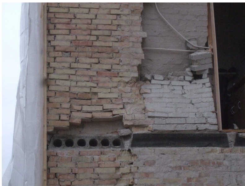
Figur 11. Delvist skadet murværk i tværskillerum op til den kollapsede sektion (SBI, 2014).
