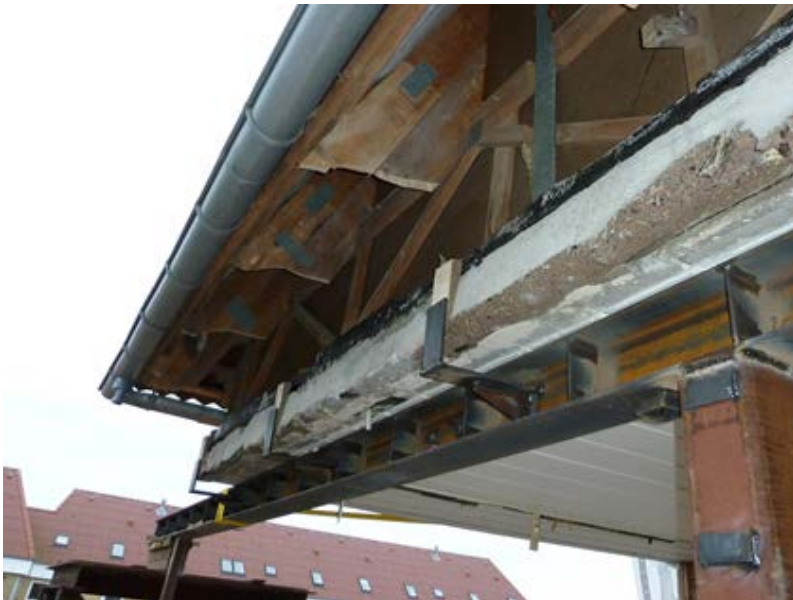
Figur 12. Taghjørne over de kollapsede lejligheder. Den understøttende I-bjælke er opsat efter kollapset. På denne hviler huldækelementer, der er gulv for tagboligen samt dele tagkonstruktionens træspær (SBI, 2014).
