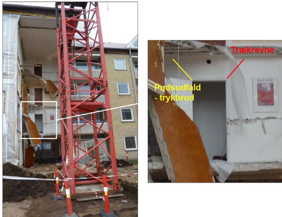
Figur 15. Revner på 1. sal før kollaps. Det er skitseret, hvor beboeren angav, at revnerne opstod umiddelbart før kollaps (SBI, 2014).
