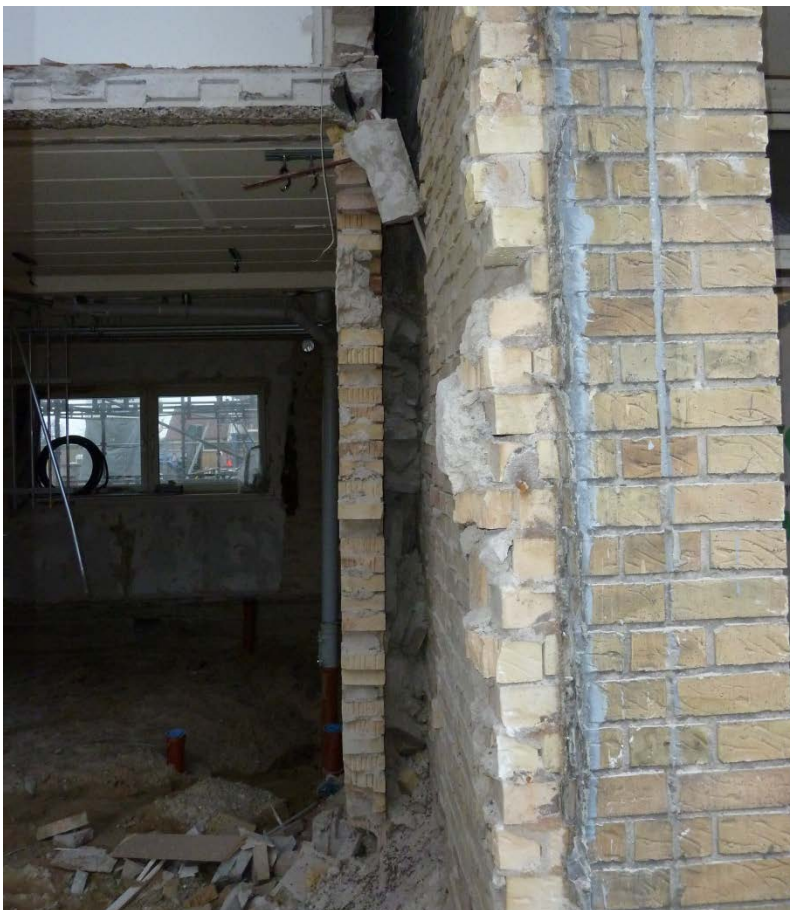
Figur 16. Billedet viser stueetagen ved den kollapsede gavl. Det ses, at gavlvæggen er kollapsed helt ind til de langsgående vægge i de kollapsede lejligheder. Længere inde ses den del af gavlvæggen, som er blevet stående (SBI, 2014).
