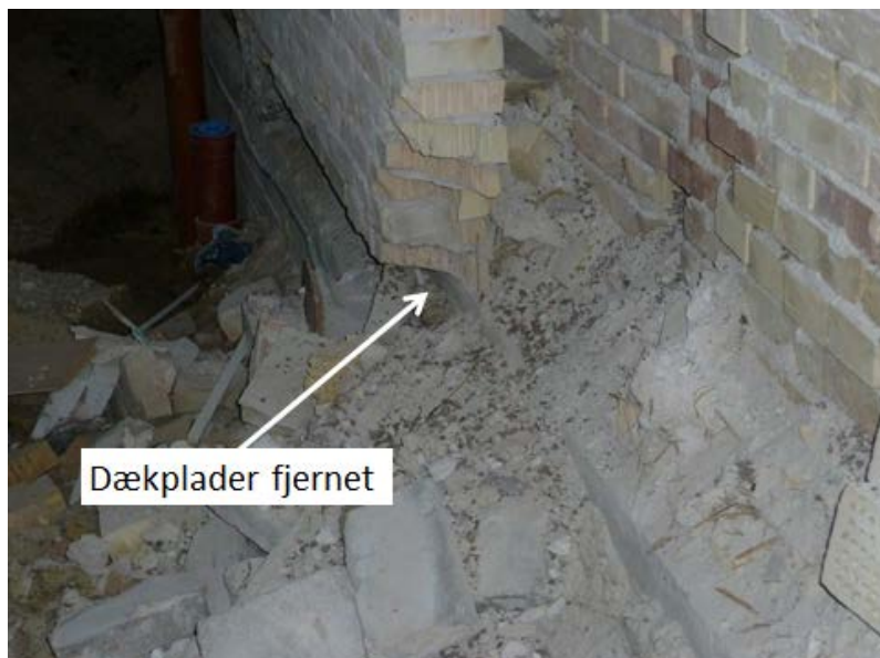
Figur 9. Forrest ses fundamentets overside ved den kollapsede del af væggen, og længere tilbage ses den nederste del af den del af gavlvæggen, der blev stående (SBI, 2014). Se også tegningen i Figur 8.
