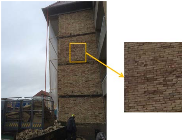
Figur 10. Gavlvæggen kort før kollaps. Til højre ses at fuger er dårligt udfyldte (NCC Construction, 2014c).
