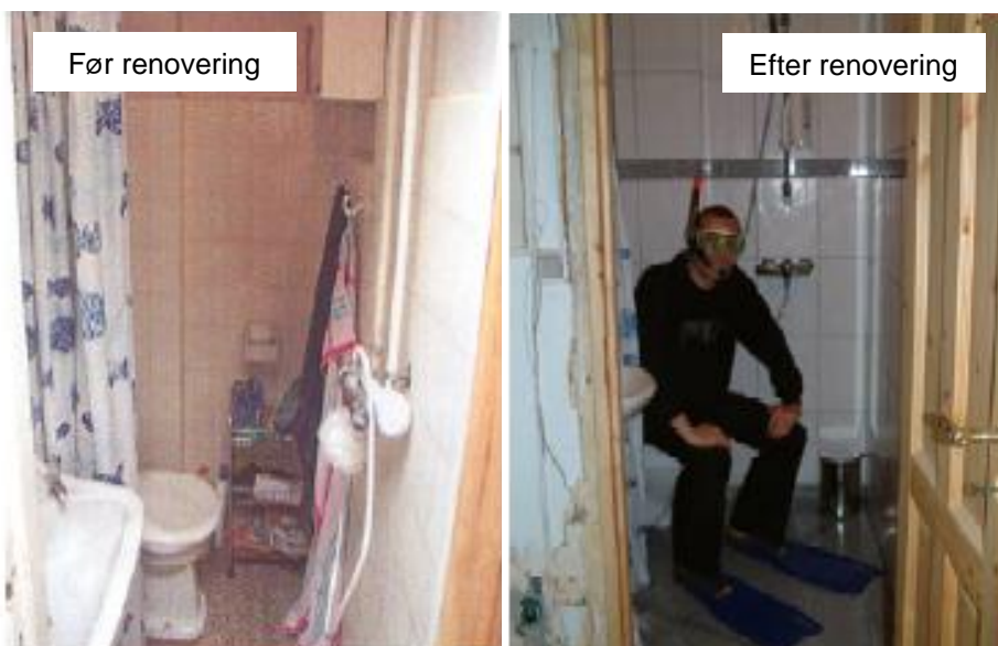
En renovering af et lille badeværelse opfyldte ikke kundens forventninger, men kan og vil det ansvarlige firma tolke det af det tilsendte 'efter-billede' til højre.
