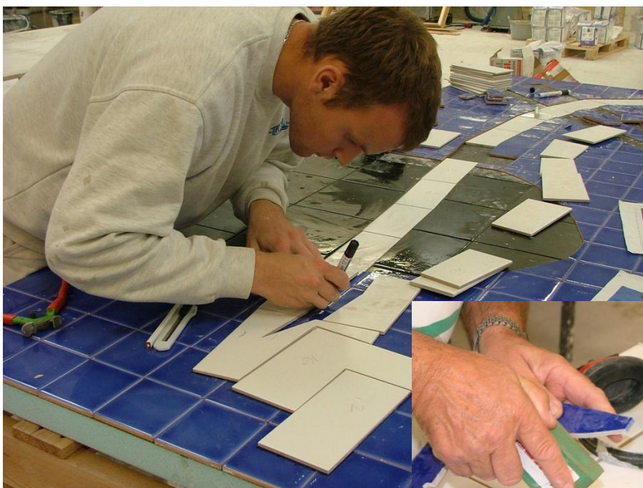
Tildannelse af fliser i et dekorativt flisemønster, som er udført hos EUC-Sjælland efter oplæg fra lokal kunstner.
