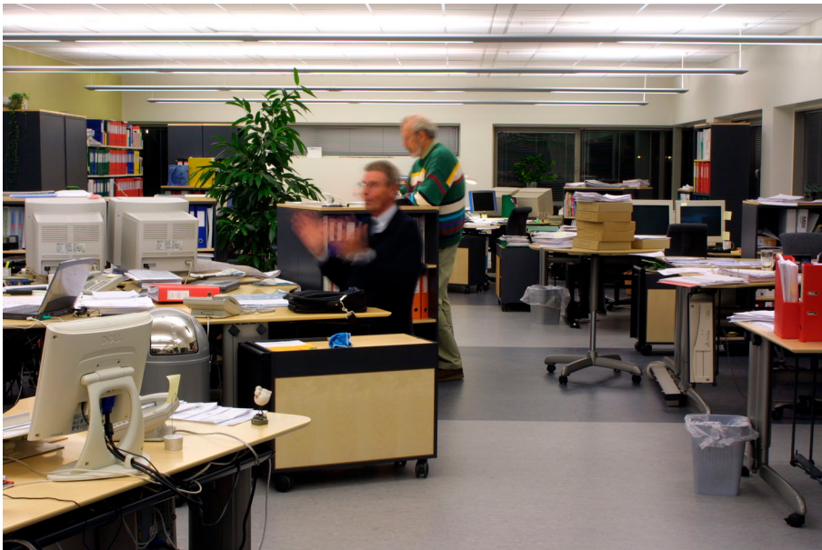
Figur 3. COWI A/S: Nedhængte, opad/nedadlysende armaturer.
