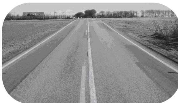
Figur 55. Belægning og vejafmærkning i km 2,20.
