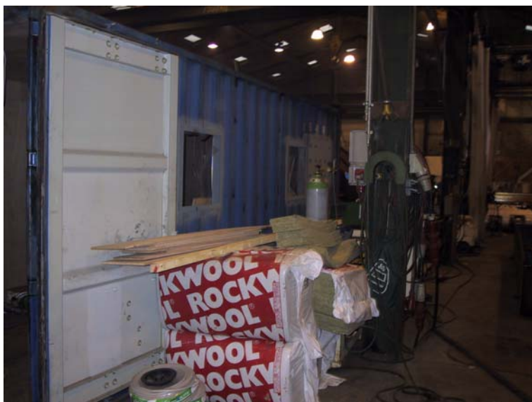
Målecontainer forsynes med vinduer.
