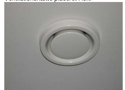
Ventilationshætte placeret i loft.
