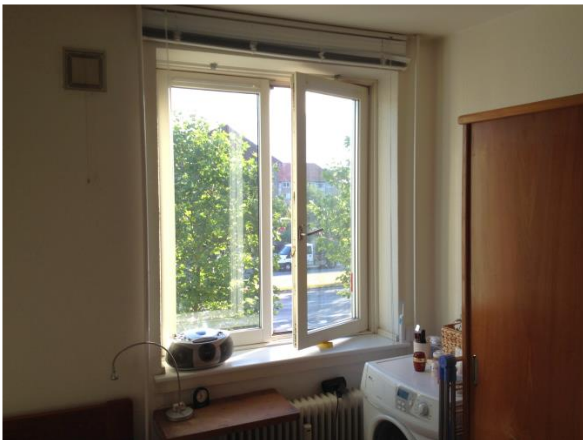
Vinduet med et åbningsareal på 0,35 \text{ m}^2 . Øverst til venstre ses dækslet til den nu blændede udeluftkanal.
