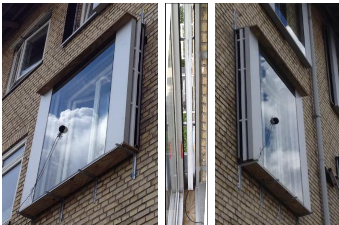
Den udrykkede lydskodde med ekstra 40 mm isolationsmateriale monteret i den 103 mm dybe spalte mellem lydskodde og den eksisterende isolering på facaden. I midten de ekstra 40 mm isoleringsmateriale fotograferet indefra.
