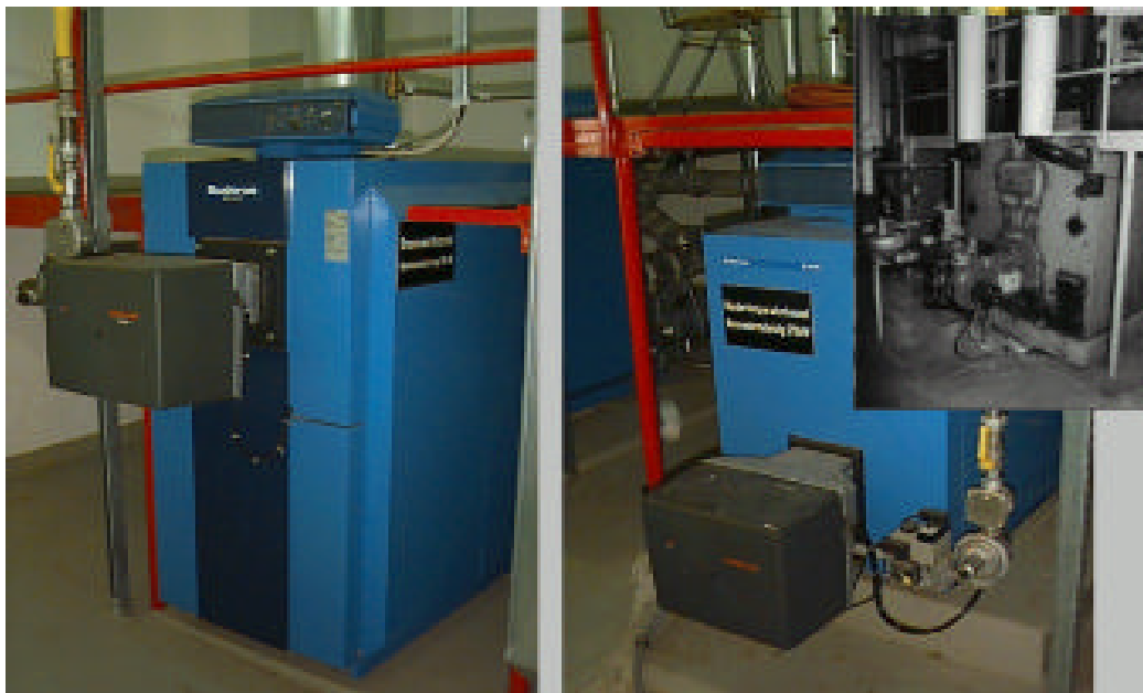
Bild 46: Neu installierte Niedertemperatur- (rechts) und Gasbrennwert-Kessel (links).
