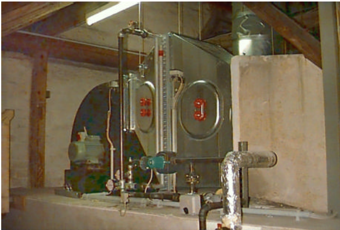
Bild 81 Heizregister der Zuluftanlage der Turnhalle.
