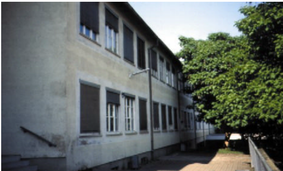
Bild 6: Leichte Putzschäden neben dem Haupteingang der GHS Plieningen. Ebenfalls zu erkennen sind die stark verschattenden Bäume direkt vor der Fassade
