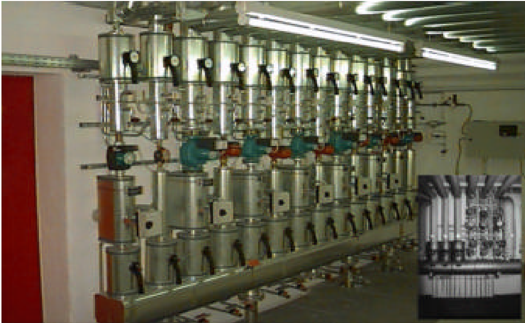
Bild 47 Neu installierte Heizkreisverteilung mit 7 getrennten Heizkreisen.
