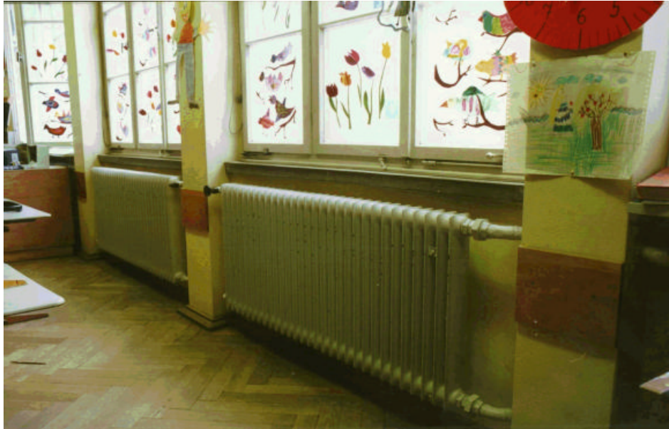
Bild 21: Wärmeübergabe in Gebäude 1 durch Gußgliederheizkörper mit Handstellventilen
