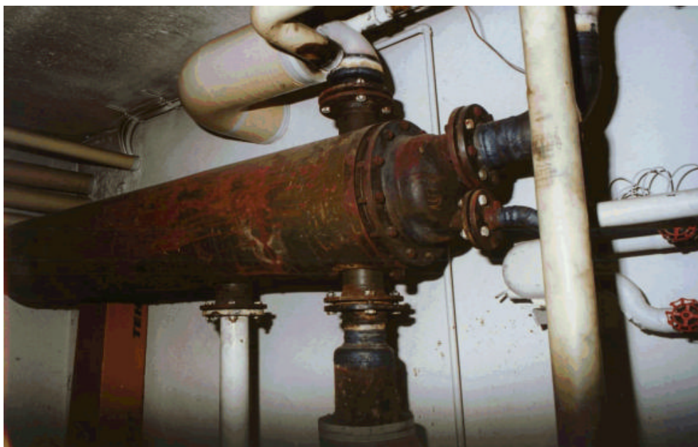
Bild 22: Dampf-Warmwasser Wärmetauscher im Heizungsraum
