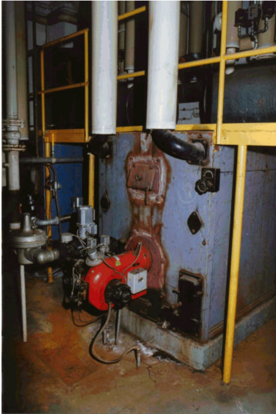
Bild 19: Niederdruckdampf-Heizkessel und Brenner mit Feststoffklappe und Heizmittelanschlüssen.
