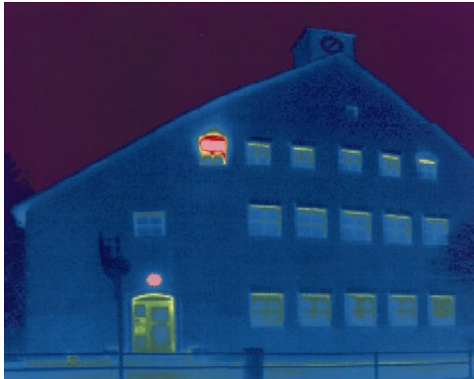
Bild 53 Thermographie der Westfassade von Gebäude 1 nach der Sanierung. Das Küchenfenster der Hausmeisterwohnung im Dachgeschoss ist gekippt
