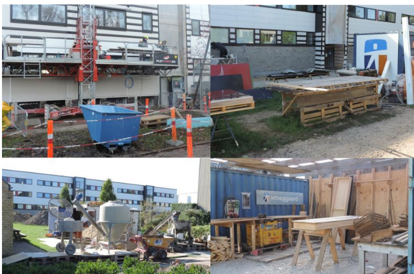
FIGUR 16. Eksempler på forskellige arbejdsstationer på byggeplads til renovering af en almen boligbebyggelse i Aarhus. Her bearbejder byggesjak og fagentrenerer materialer og byggevarer, inden de kan montere dem på den enkelte bygningsdel og gentagelse. I øverste venstre billede er vist flytbar arbejdsplatform til renovering af facadeafsnit. I øverste højre billede er vist flytbart tilskæringsbord foran indgang. I nederste venstre billede er vist flytbar betonblandestation mellem 2 boligblokke. I nederste højre billede er vist fast bukkestation for armeringsjern på fælles lagerplads, som ikke flyttes.
