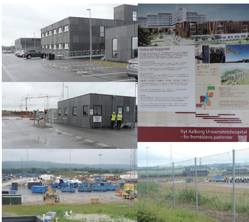
FIGUR 19. Eksempler på indretning af fælles funktioner ved bygning af Nyt Aalborg Universitetshospital (NAU) i Aalborg Øst. I øverste venstre billede er vist fælles kontorer og møderum. I midterste venstre billede er vist portindgang til byggepladsen. I øverste højre billede er vist fælles skiltning. I nederste venstre billede er vist fælles lagerområde. I nederste højre billede er vist indhegning, som lukker hele byggepladsen af, og hvor der er døgnvagt på.
