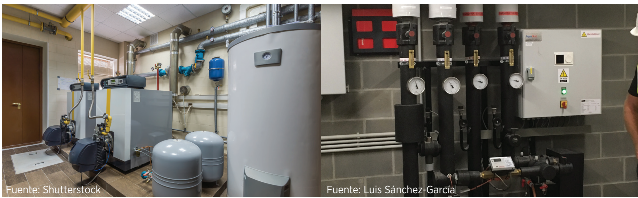
Fotografía 5 Calderas de gas en una sala de calderas de gas (izquierda) y una subestación en un edificio en Bélgica (derecha)
