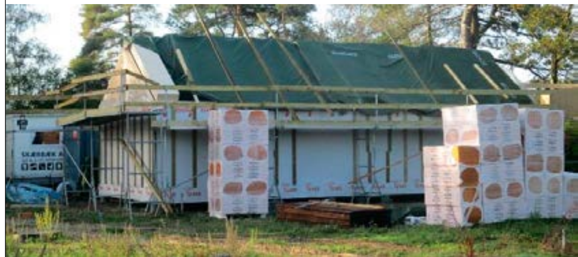
Modulhus 1 opført af træmoduler udført på stedet skal beskyttes mod vejrlig, © Peter Ib Rasmussen.
