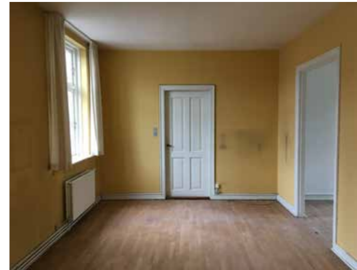
Billeder inden byggestart. Farverne føres ind i det nye projekt, som en reference til historien.
