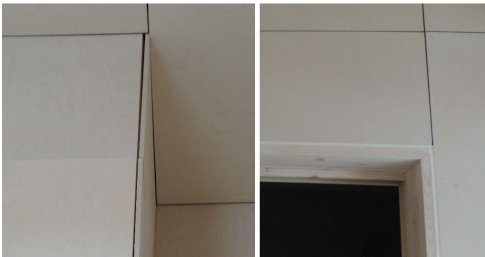
FIGUR 31. Fastgørelse af birkefinerpladerne svigter nogle steder, så mellemrummene gaber. Se eksempel på billedet til venstre. Der er anvendt plastisk fugemasse mellem dørkarm og birkefinerpladerne, hvilket ikke passer sammen med de øvrige fuger mellem birkefinerpladerne, som er åbne. Se eksempel på billedet til højre. Foto: Niels Haldor Bertelsen (2021).
