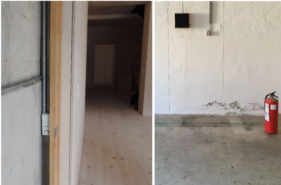
FIGUR 27. Samling mellem 'Hus i Hus' konceptet og den gamle ydervæg på billedet til venstre. Fugt gennemslag nederst på væg i opgang på billedet til højre. Foto: Niels Haldor Bertelsen (2021).
