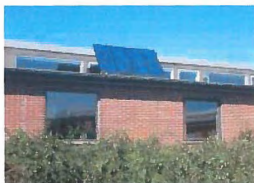
Solcelleanlæg på Brædstrup Skole i forbindelse med projektet 'Solen I Skolen', hvor solcelleanlæg knyttes til fysikundervisningen. (9)
