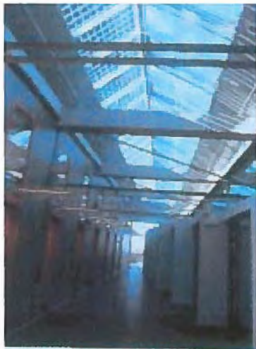
Atrium, hvor sydvendte blændparti i shedtag er erstattet med termorude med integrerede silicium solceller. (5)
