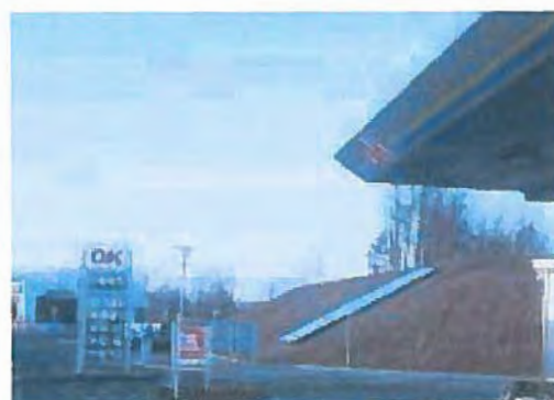
Solcelleanlæg, 4kWh, på sydendt jordskråning ved OK benzin i Korsør, i forbindelse med projektet SOL Erhverv. (10)
