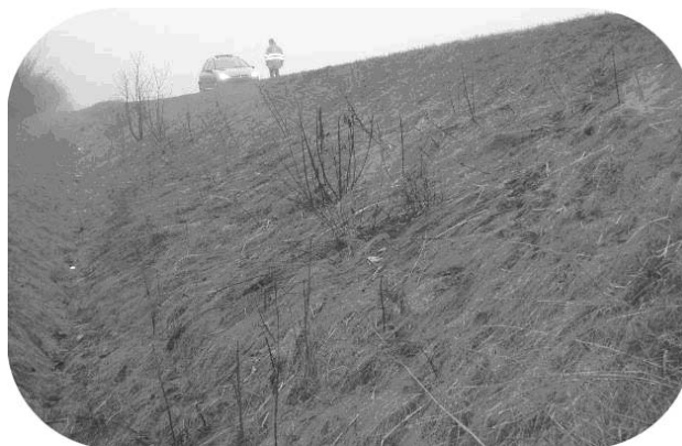
Figur 59. Dyb, uafskærmet grøft i strækningens sydlige side i km 2,27.
