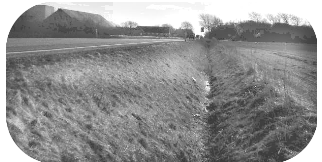
Figur 50. Dyb grøft i strækningens vestlige side ved km 6,95.
