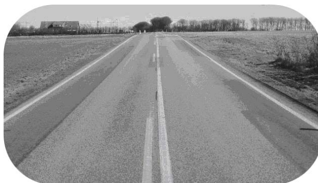
Figur 55. Belægning og vejafmærkning i km 2,20.
