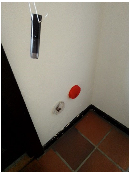
FIGUR 31. To fugthætter (USB datalogger) monteret på ydervæg af letbeton med puds og maling. Yderligere ses måler, der registrerer temperatur og RF i rumluften.
