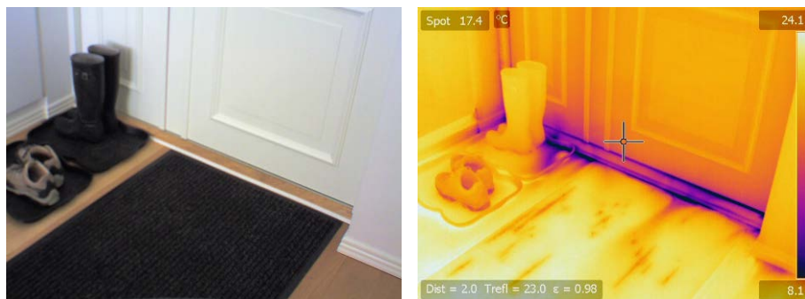
Figur 16. Utætheder under bundstykket ved hoveddør (hus 20).
