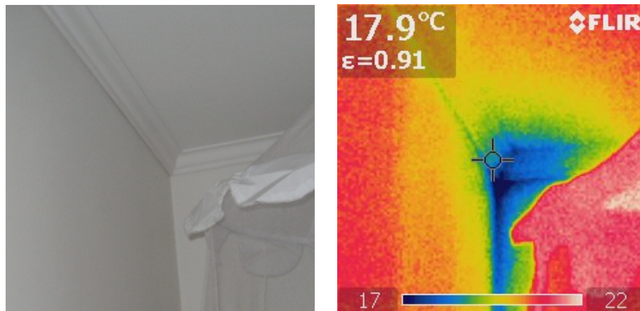
Figur 2. Samme motiv i henholdsvis almindeligt foto og termografifoto. Billedet viser et indvendigt hjørne i et børneværelse. Billedet er fra én af boligerne i Herfølge, Fremtidens parcelhus.
