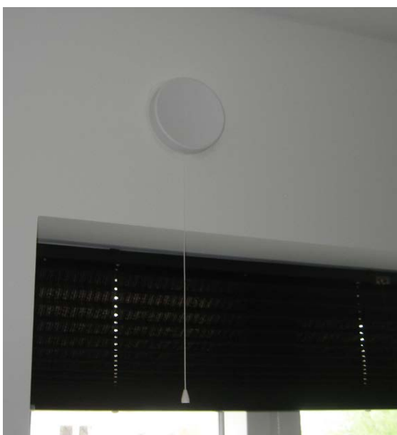
Figur 23. Tallerkenventil over vindue (lejlighed nr. 7).
