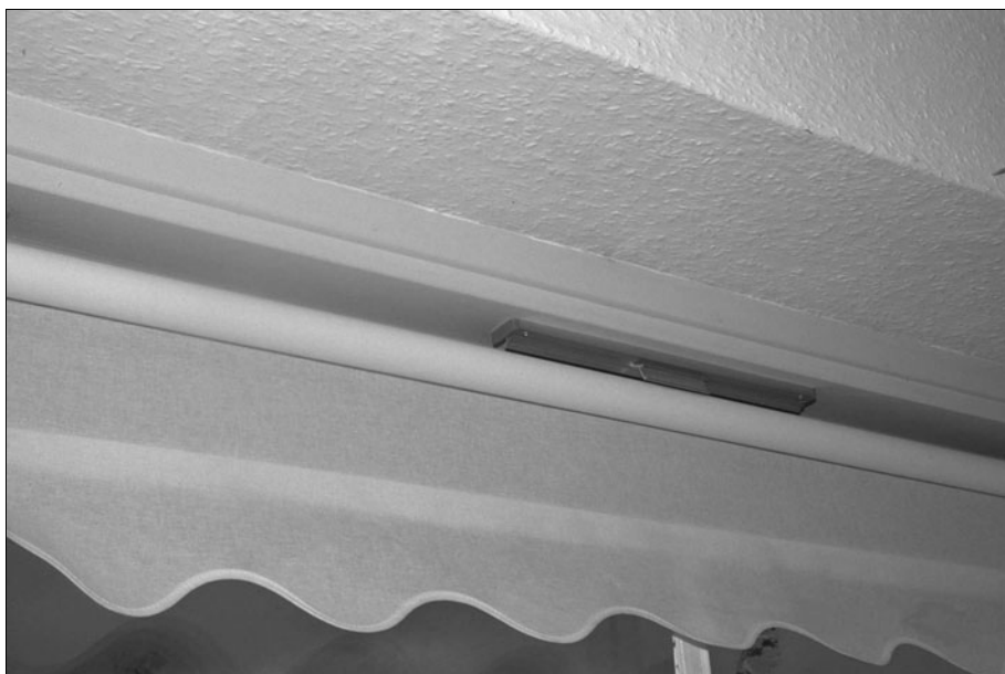
Figur 8. Udeluftventil integreret i vinduesrammen.
