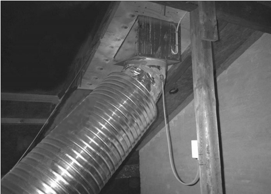
Figur 10. Taggennemføringen set inde fra loftsrummet. Udsugningsventilatoren er monteret i en taggennemføring i tagfladen, så afkastet højdemæssigt er over bygnings tagryg. Under taggennemføringen og udsugningsventilatoren ses lyddæmperen.
