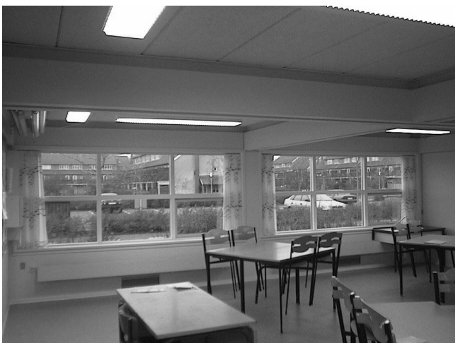
Figur 4.8. Skole E. Skolen er en ombygget åben-plan skole med forholdsvis dybe klasselokaler. Adgangssituationen fra fællesareal til klasser virker dunkel, da lysniveauet i fællesarealet er højere end i klasserne, og der er oplevelsesmæssigt lysere og rarere i fællesarealet end i klasselokalerne.
