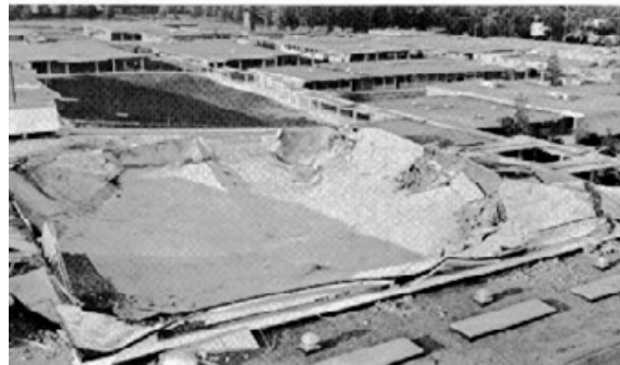
Figur 11. Den 14. september 1970 kollapsede tagkonstruktionen, der var sammensat af fire HP skaller ( www.ketchum.org/shells ).
