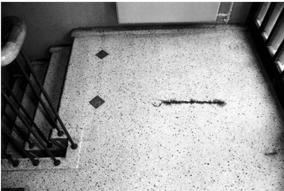
Figur 6. Armeringsjernet er synligt flere steder på trappen og terrasogulvet er knækket.
