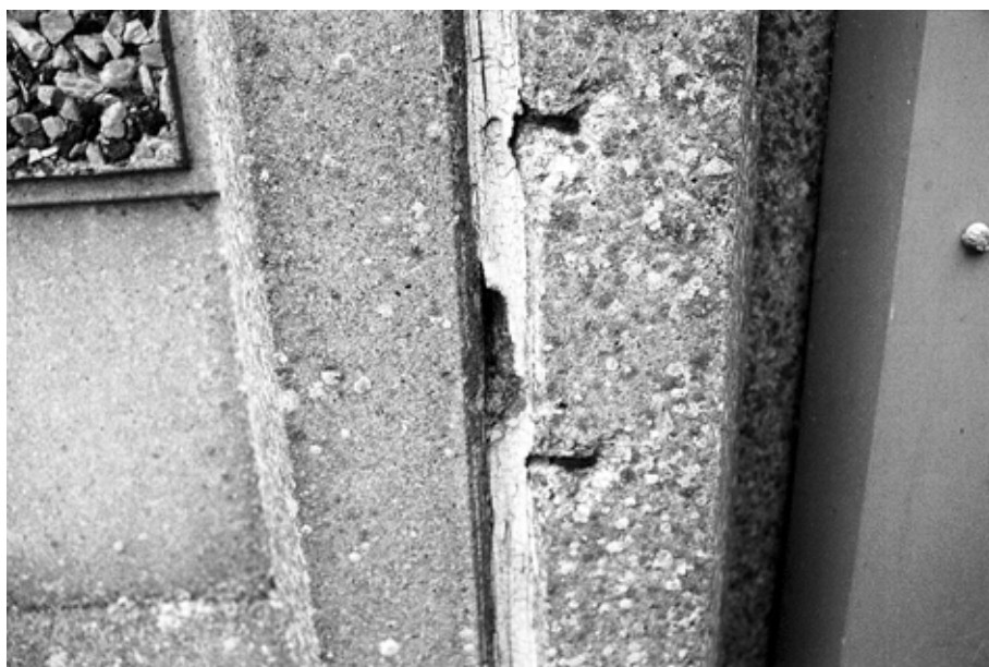
Figur 2. Betonen er afskallet på elementet og armeringen er synlig.
