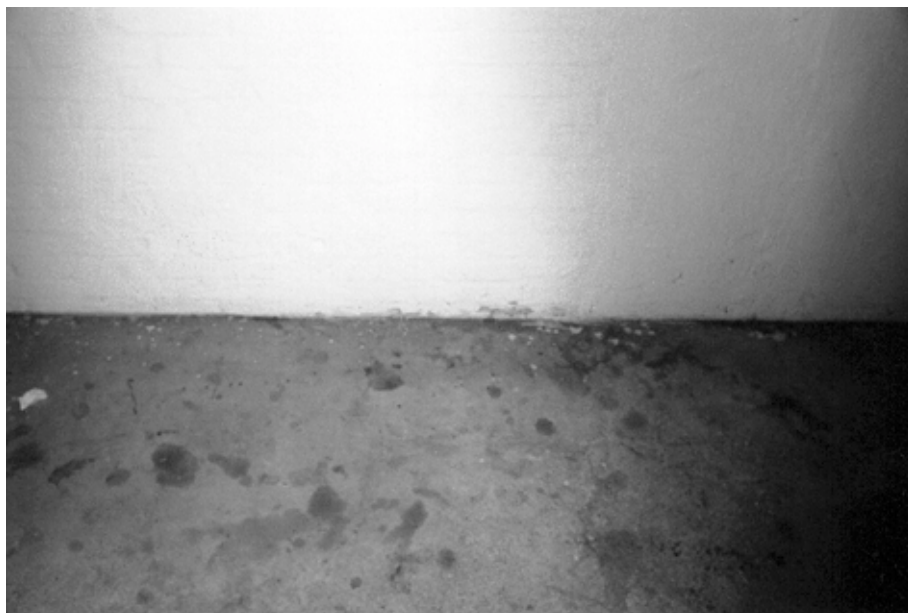
Figur 5. Kældergulvet er revnet og ved måling på væggen kunne det konstateres, at der var lidt opstigende grundfugt.
