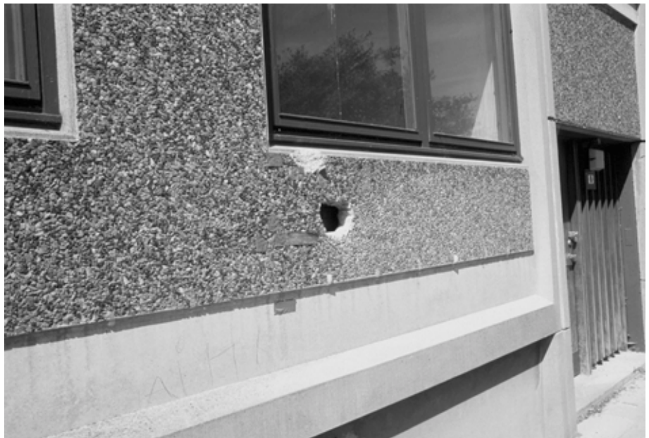
Figur 10. De blå sedler viser, hvor der er armeringsjer i facaden. Hullet er udført for at se nærmere på armeringsjernene.
