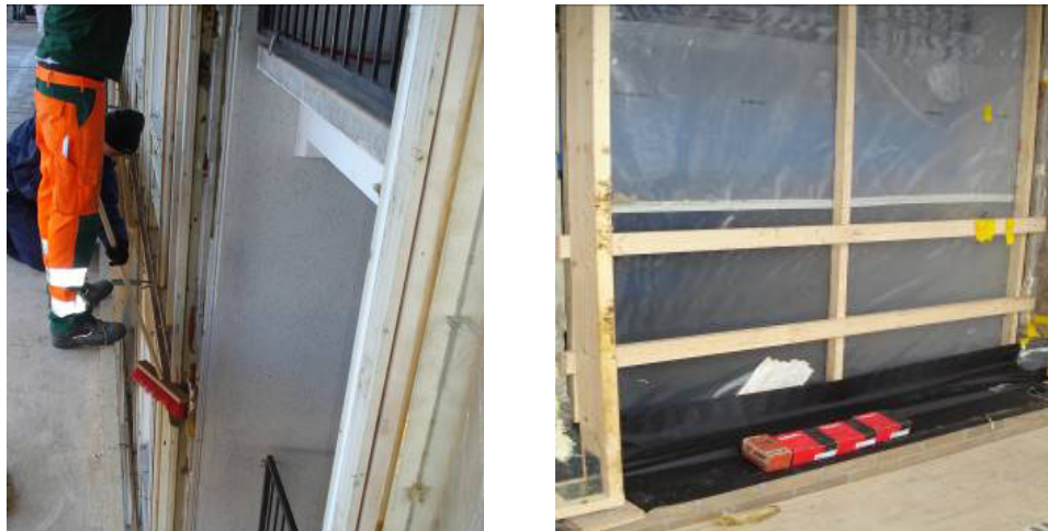
Figur 4. Eksempel på løsning udtænkt umiddelbart i forlængelse af sikkerhedsmøde: Afdækning af trappeopgang efter fjernelse af eksisterende vinduer. Efter fjernelse af de eksisterende vinduer opstod en åbning med stor risiko for faldulykker (billedet til venstre). Åbningen blev afdækket med en løsning alle parter kunne acceptere (billedet til højre).
