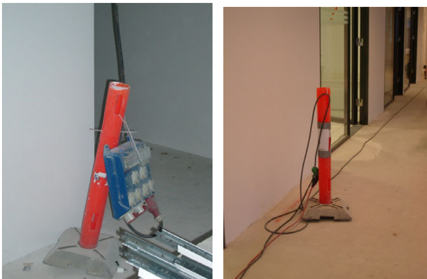
Figur 13. Ophængning af undertavle og ledninger på kegler for at få styr på løse ledninger.
