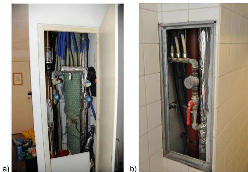
Figur 37. a) Adgang til installationsskakt via inspektionslem i rumhøjde og b) adgang via lem i badeværelse.
