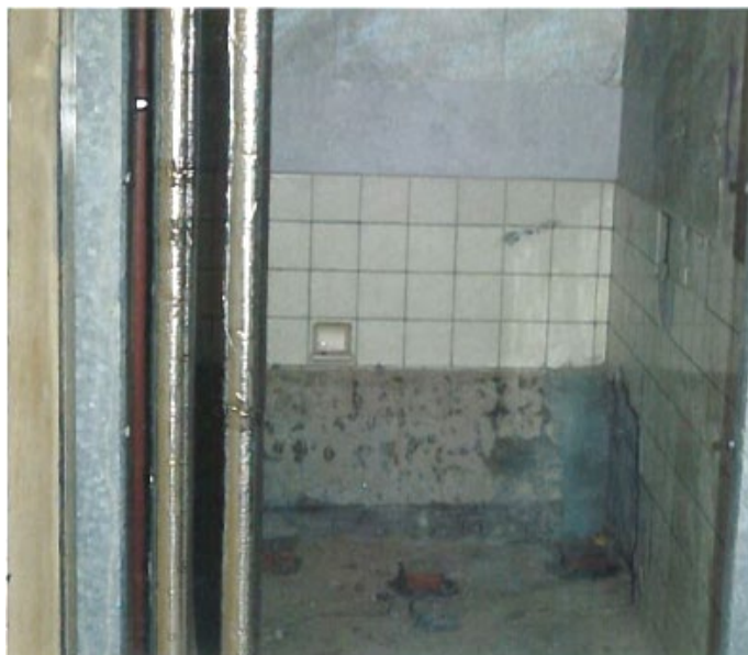
Figur 24. Lette badeværelselementer med stålmembran i gulv.
