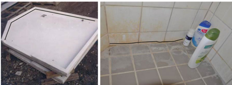
Figur 80. Til venstre ses en fiberarmeret gulvplade med sokkelokant (markeret med en sort linje). Til højre ses en revne i det færdige badeværelse med bund som til venstre. Revnen (den sorte linje) følger sokkelokanten på gulvpladen.
