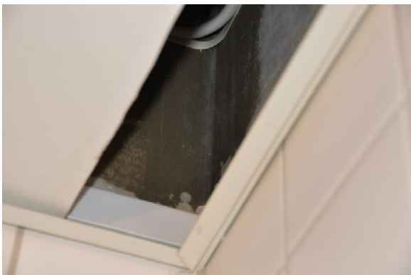
Figur 49. Samling mellem væg-væg over nedhængt loft. Igennem den sorte membran kan anes et net som vurderes at være en armering og membran over samling.
