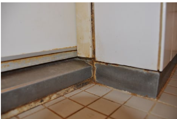
Figur 81. Den rustrøde farve på metaloverfladerne formodes at være skimmelsvamp og ikke rust. På den elastiske fuger under døren, er der sort skimmel.
