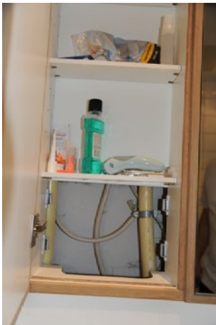
Figur 23. Adgang til installationer bag toiletet via et skab, se også Figur 20a.
