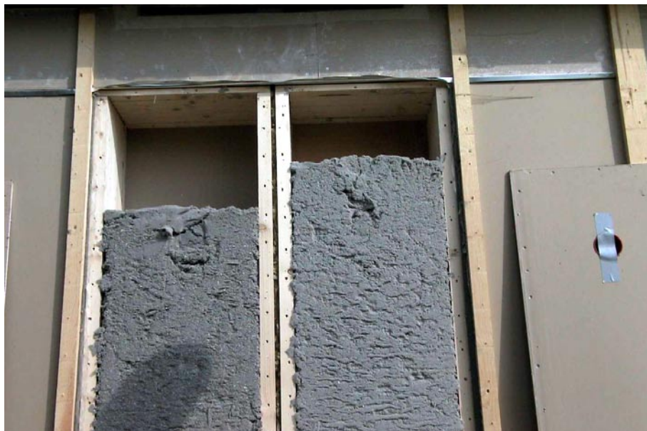
Figur 11. Sætning i Papiruld ved demontering af element. Den største del af sætningen skete i forbindelse med åbningen af elementerne. Efterfølgende forsøg tyder på, at den del af sætningen, der skete før elementerne blev åbnet, skyldtes, at vægtykkelsen er 285 mm, mens den indblæste densitet ville være acceptabel til en 190 mm tyk isolering.
