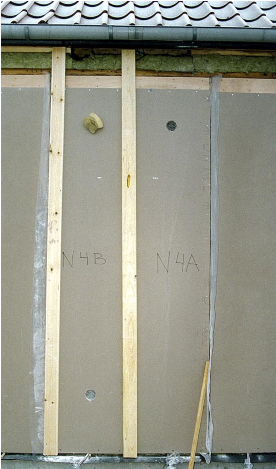
Figur 10. Element 4B til venstre forstærket med trælægter og med to "indblæsningshuller" så luften kan slippe ud af elementet.
