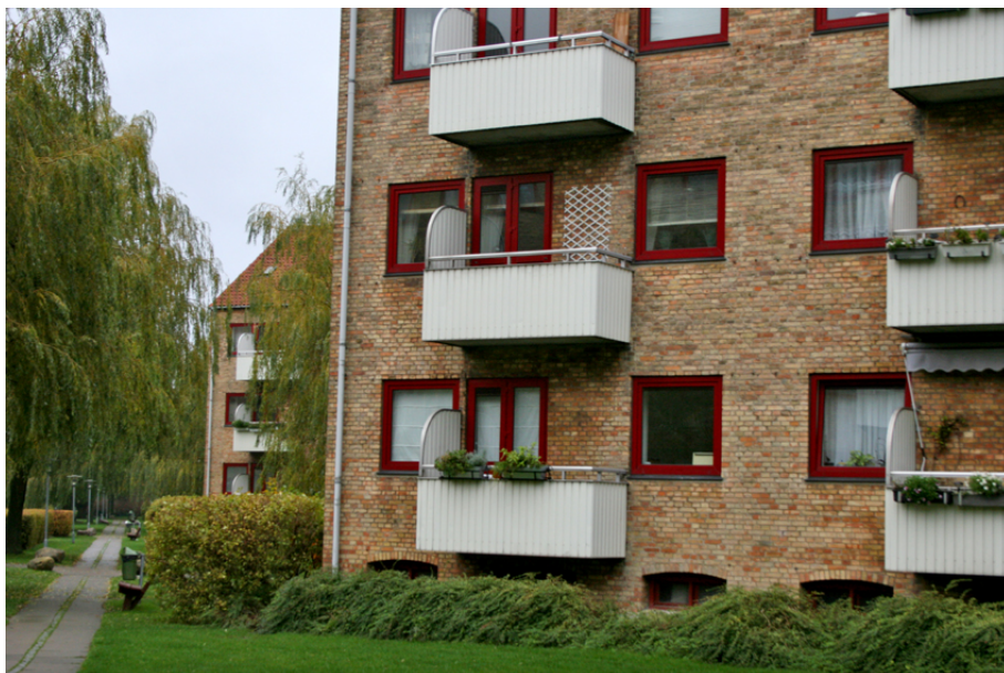
Figur 5. Etagebolig fra 30'erne, facade ved altaner.
