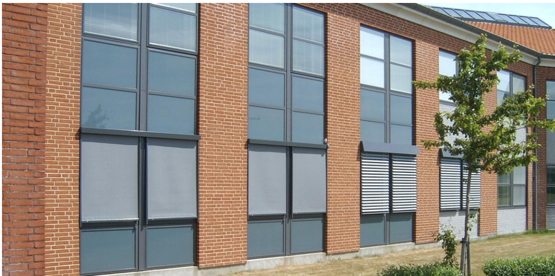
Figur 36. Udvendt foto af det udvendige gardin (til højre i billede) og den nye persienne (til venstre i billede). De to solafskærmningssystemer blev monteret på to vinduesfag.
