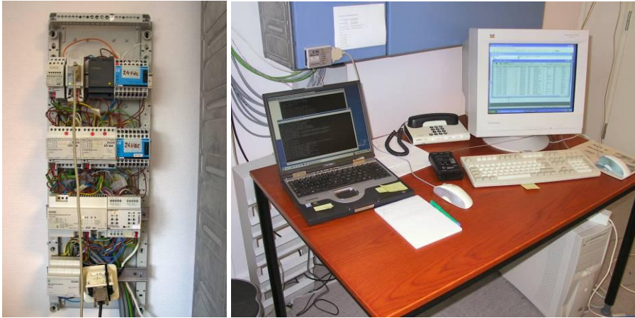
Figur 25. Ny EIB-Bus (til venstre) baseret på et switch-board viser moduler, strømforsyning og to kommunikationsinterfaces. Til højre er laptop med ECCO-Controller software og stationær PC for opsætning af actuators, dataopsamling osv. Under hele forløbet var der fuld adgang, via internettet, fra deltagerne i EU-projektet.
