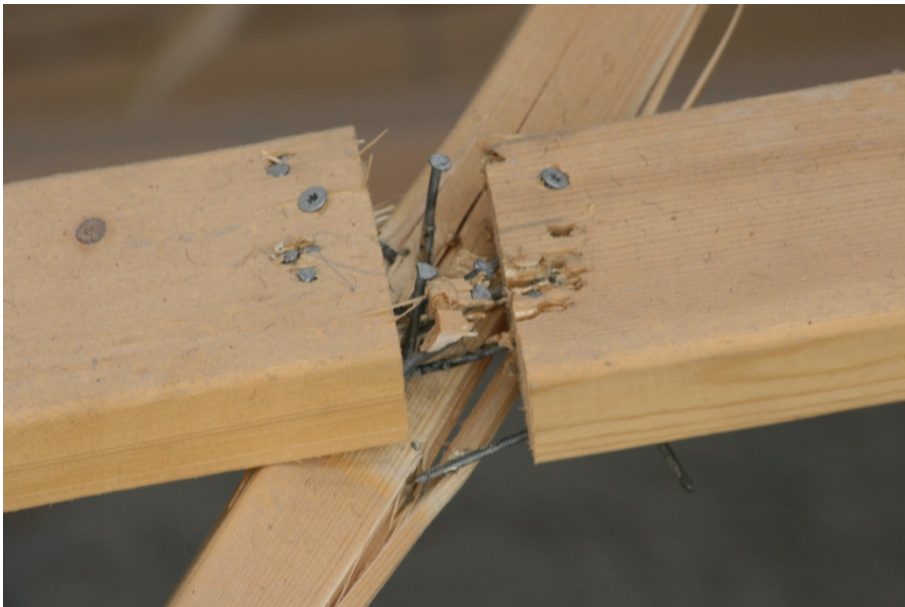
Figur 10. Brud i stød i afstivning på hanebånd. Foto: SBI.
