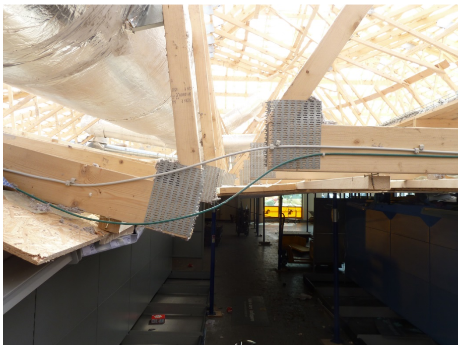
Figur 23. Stød i spærfødder med overrevne sømplader. Foto: SBI.
