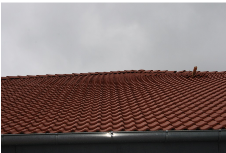
Figur 8. Østvendt tagflade gennembrudt af afstivning. Foto: SBI.
