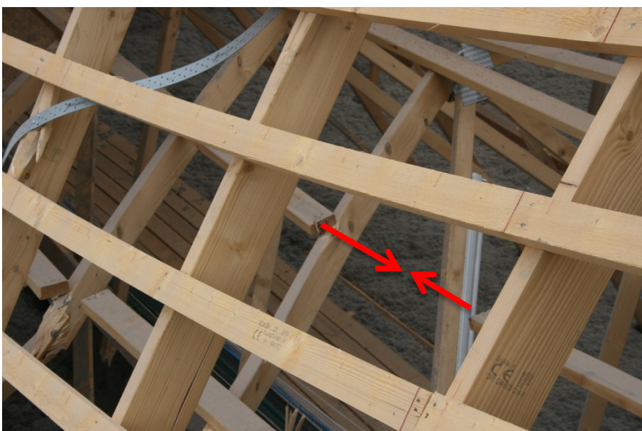
Figur 12. Brud i stød i afstivning på hanebånd. Pilene indikerer, hvor adskillelsen er sket. Foto: SBI.
