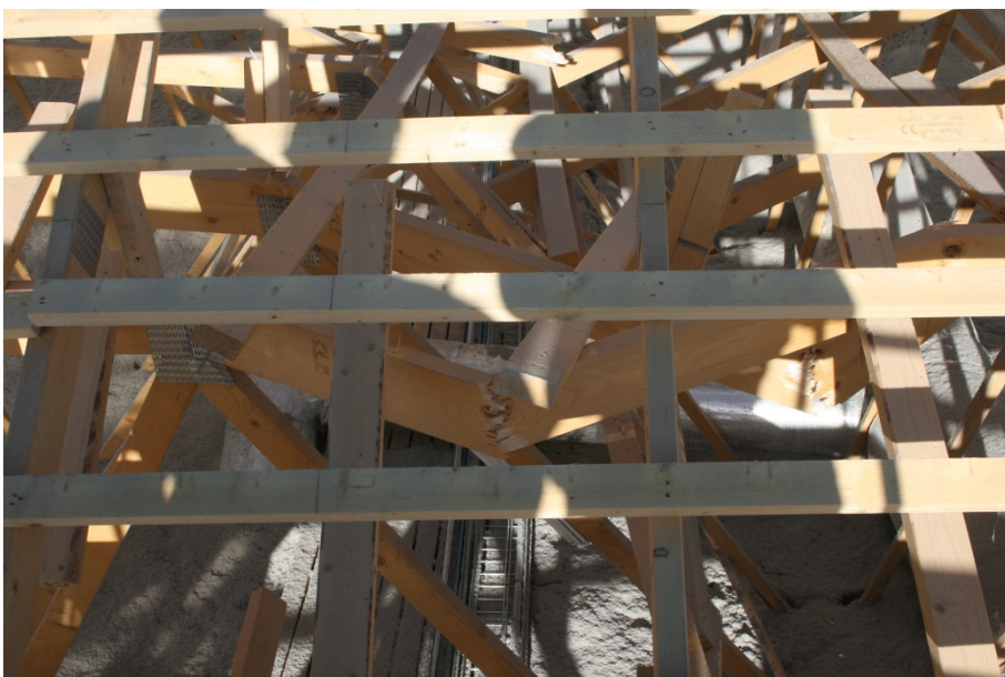
Figur 16. Bøjningsbrud i valmspærs spærhoved. Foto: SBI.
