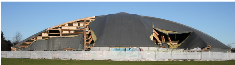
Figur 4. Kollapsede områder i sydlig apsis ved systemlinje 10, 9, 8 og 5.
