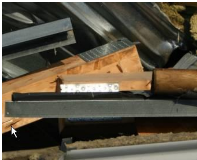
Billede A11. Overrevet sømbeslagsforbindelse i randbjælken
