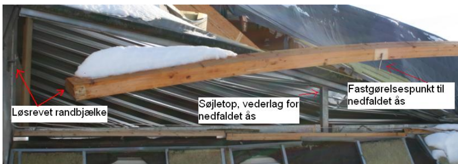
Billede A8. Løsrevet randbjælke samt søjletop og fastgørelsespunkt for åsen.
