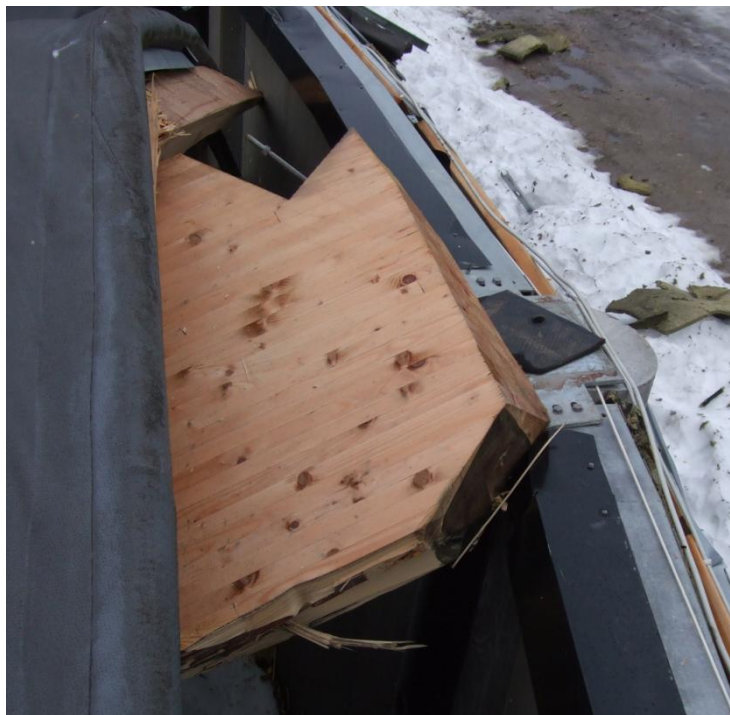
Billede A2. Buen i systemlinje 8 er flækket ud fra understøtning og 'underflangen' er faldet ned.
