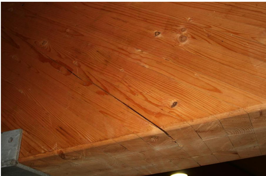
Figur A12. Nordlig apsis-hal. Revner i buen ved vedertag i systemlinje 6 set fra øst (den viste understøtning er placeret efter kollapset).
