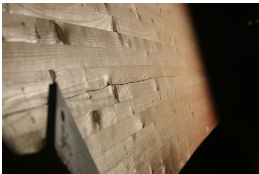
Figur A15. Nordlig apsis-hal. Revner i buen startende ved vederlag og forløber langs buen i systemlinje 6, set fra vest (den viste understøtning er placeret efter kollapsedet).
