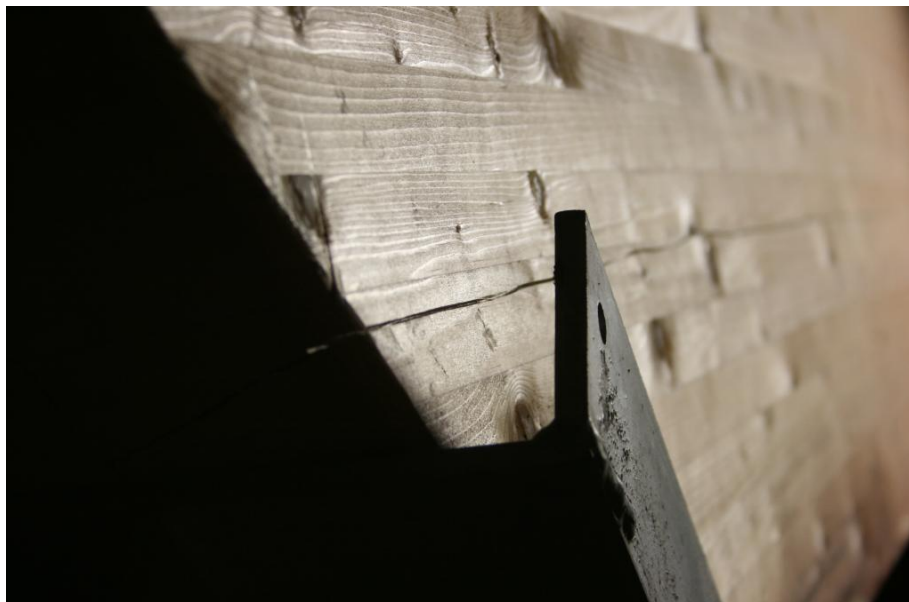
Figur A14. Nordlig apsis-hal. Revner i buen ved vederlag i systemlinje 6 set fra vest (den viste understøtning er placeret efter kollapsedet).
