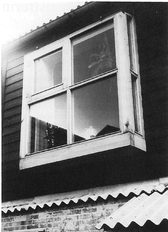
Figur 7. Tilstandsregistrering: Karnapvindue i facade af træ.
