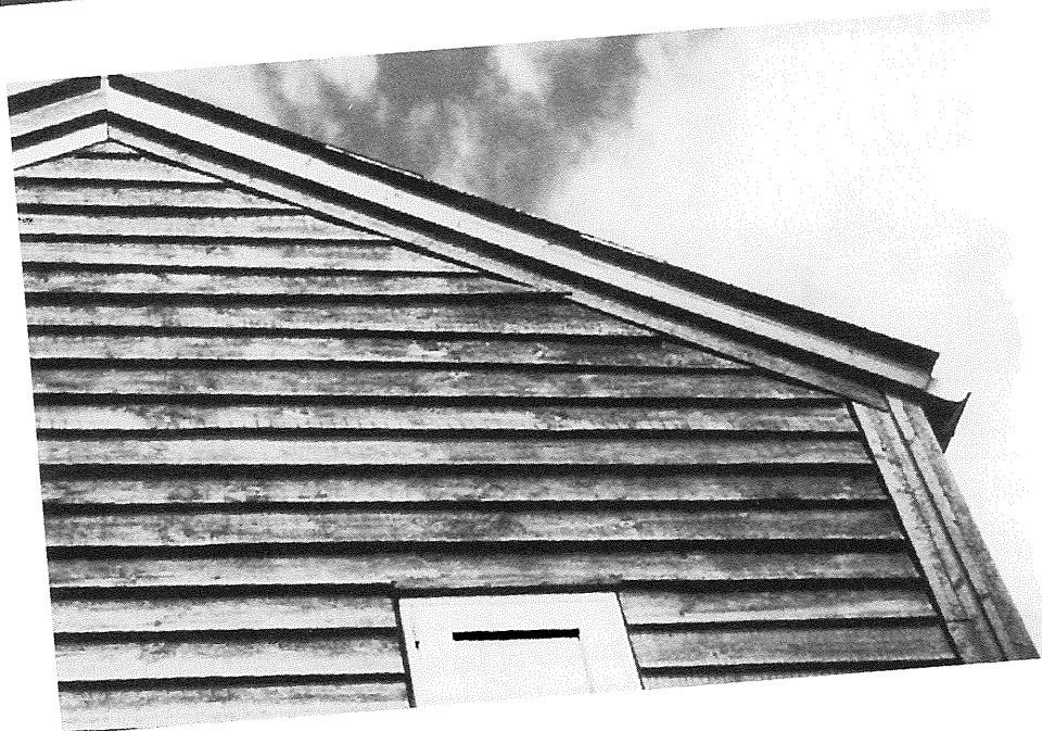
Figur 72. Tilstandsregistrering: Befæstelsessvigt i bræddebeklædningen.
