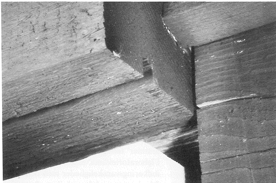
Figur 63. Den ny klima- simulator: Vandnæse over vindue efter 2½ måneds ældning.
