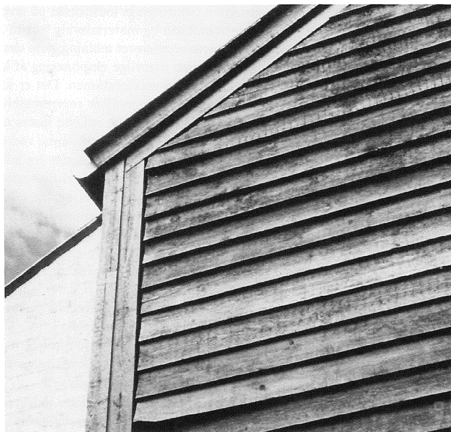
Figur 75. Tilstandsregistrering: Revne udgået fra endetræ i bræddebeklædningen.
