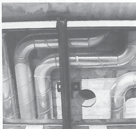
Ventilationskanaler bag solvæggen.
