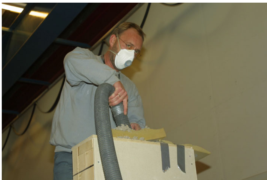
Figur 9. Hulleerne i topremnen til fødeslangen og luftudtag er dækket med polyuretanskum. Afdækningen af hullerne forhindrer papirulden i at blæse tilbage i hovedet på isolatøren. Polyuretanskummet er fastholdt med tape over luftudtaget og ved håndkraft omkring fødeslangen. I det viste tilfælde indblæses løsfyldsisoleringen, Papiruld, i en væg med de indvendige dimensioner: længde \times tykkelse \times højde lig med 0,495 m \times 0,198 m \times 2,3 m uden lægter.
