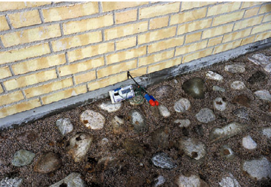
Figur 72. Måling af fugt i gipsplade bag ventileret hulrum.
