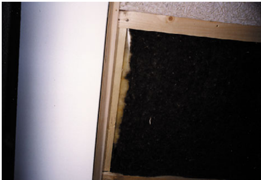
Figur 39. Loftsplade nedtaget i klasselokale. Isoleringsmåtterne når ikke hen til lægte.
