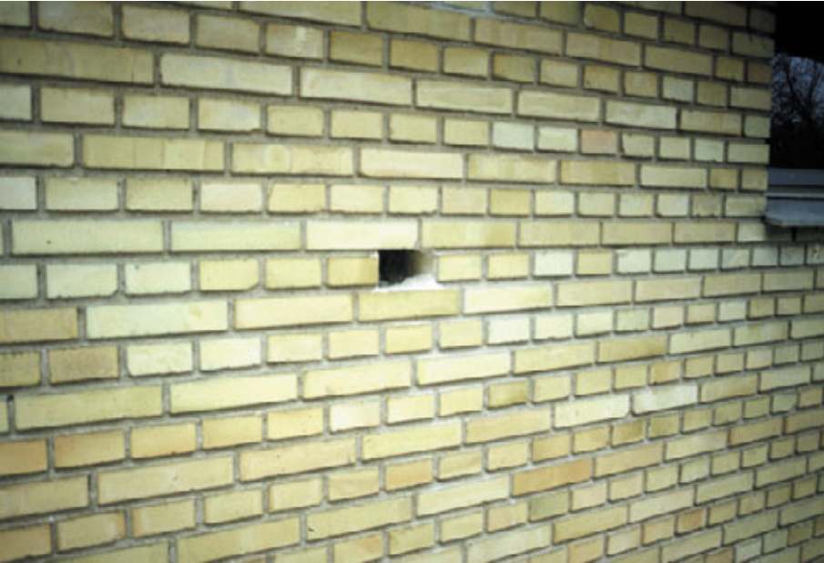
Figur 12. Mursten er udtaget på østfacaden ud for stue, våd plet efter regnvej (se figur 11). Papirisoleringen føltes tør, men den relative fugtighed målt til 92 %.
