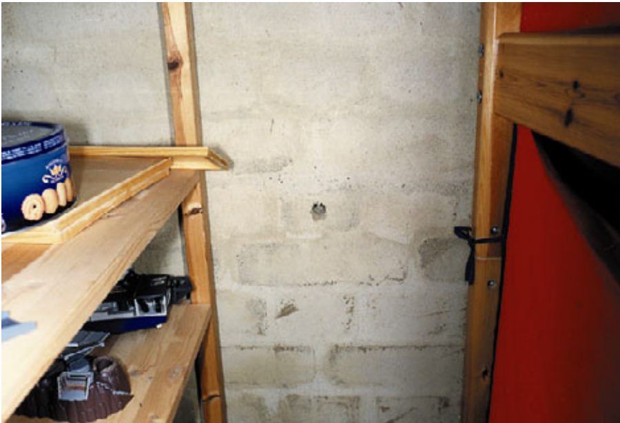
Figur 30. Hul boret i lervæg, som er lejlighedsskel.
