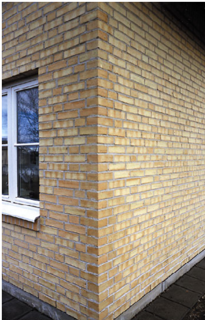
Figur 70. Vådt hjørne efter slagregn (se figur 66 og 68).
