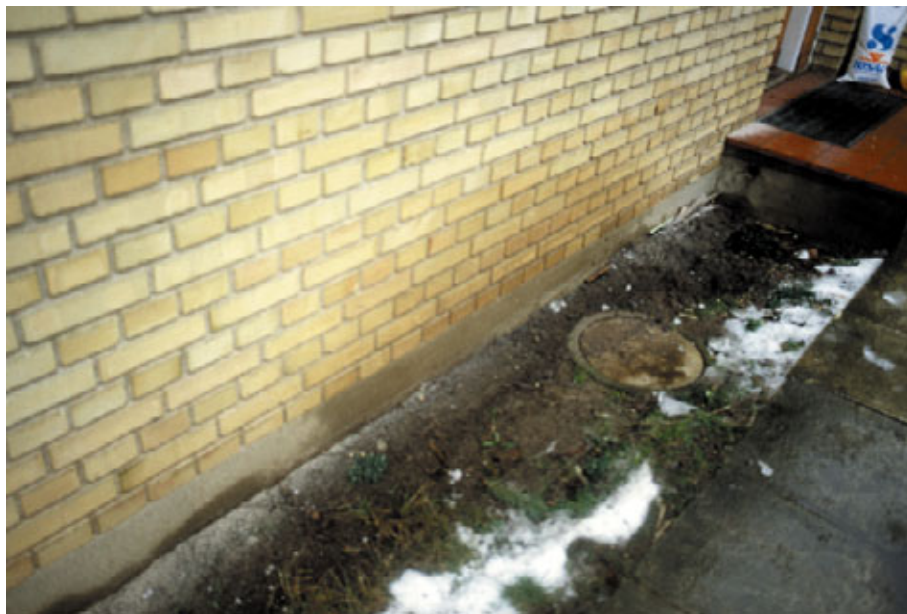
Figur 10. Østfacade ud for køkken. Vandet fra tagrenden løber over ved regnvejlr og slår op på facaden.
