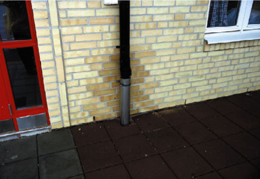
Figur 71. Koldt og fugtigt område ved nedløbsrør skyldes vand fra særlig anordning på nedløbsrør.
