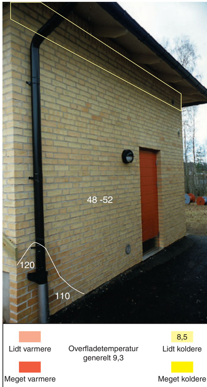
Figur 67. Nordfacade ved passage. De hvide tal angiver måling med GANN.
