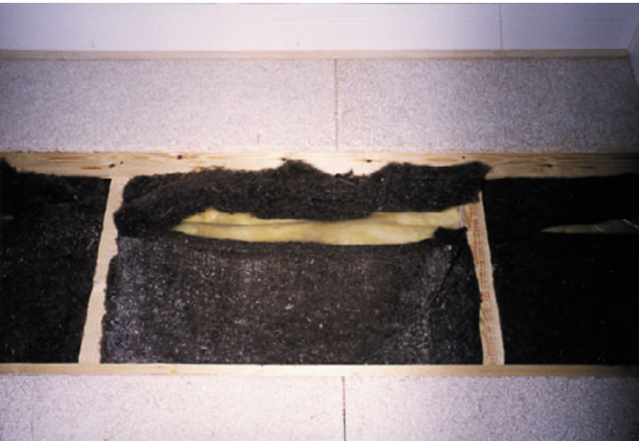
Figur 38. Loftsplade nedtaget i gangen. Isoleringsmåtterne når ikke sammen.
