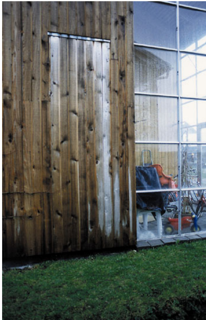
Figur 24. Gavl mod syd efter regnvej.
