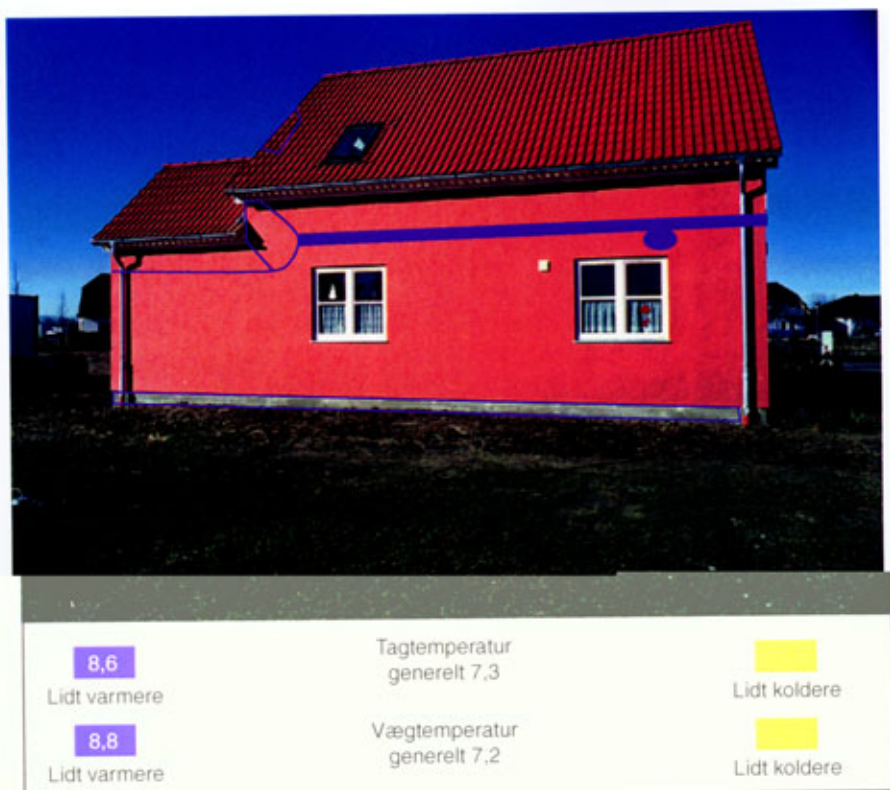
Figur 52. Facade mod øst. Det varmere område foroven ligger lige under etageadskillelsen og kan skyldes, at isoleringen ikke når helt op. Plet på tag og samling af tag og over vindue kan skyldes dårlig isolering.
