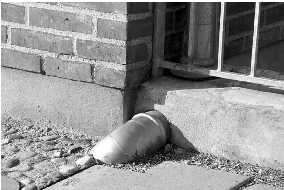
Figur 9. U hensigtsmæssig trækning af nedløbsrør.
