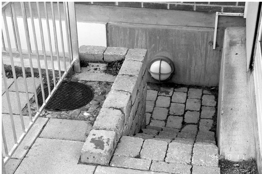
Figur 10. Udvendig trappe til kælder som på grund af manglende omtanke er blevet alt for smal pga. en brønd, som 'stod i vejen'.
