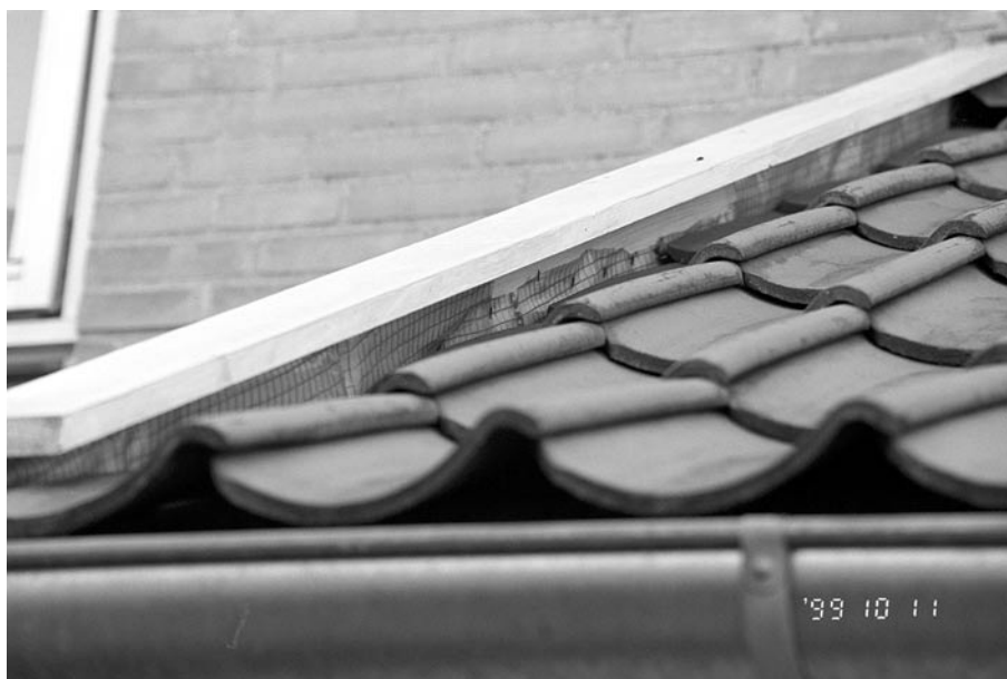
Figur 5. Dårlig afslutning af undertag på vindskede. Undertaget er frit eksponeret for nedbrydende sollys.
