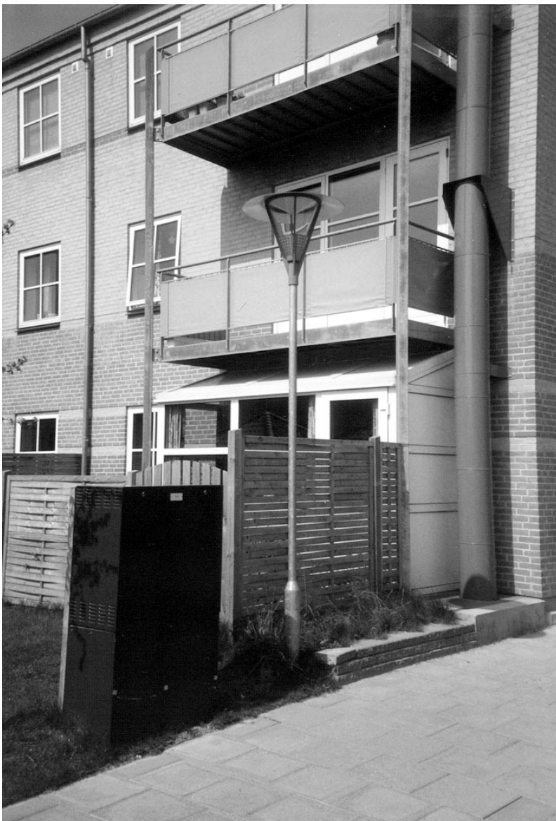
Figur 16. Facadeparti af Vojensvej 12 med de galvaniserede altaner på 1. og 2. etage og den indeklemte karnap på stueetagen.
