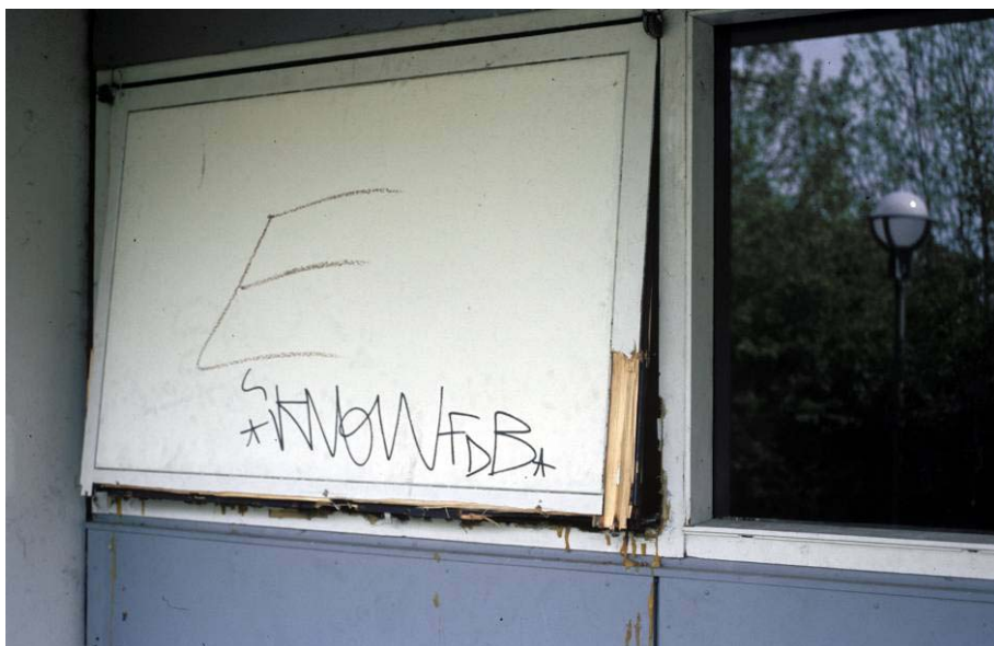
I kælderetagernes depoter og butikslokaler var ruderne smadret. Her er ruderne afskærmet med krydsfiner efter tydelige spor efter indbrud.
