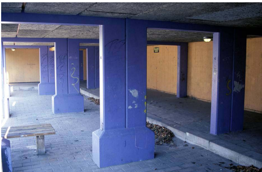
Arealerne mellem indgangene er mørke og ubehagelige, og stærkt nedslidte.
