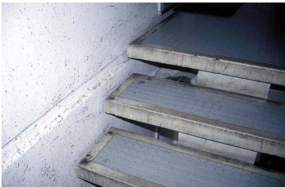
I opgangene var trappetrin, vægge og lofter nedslidte, forsømte og meget beskidte.
