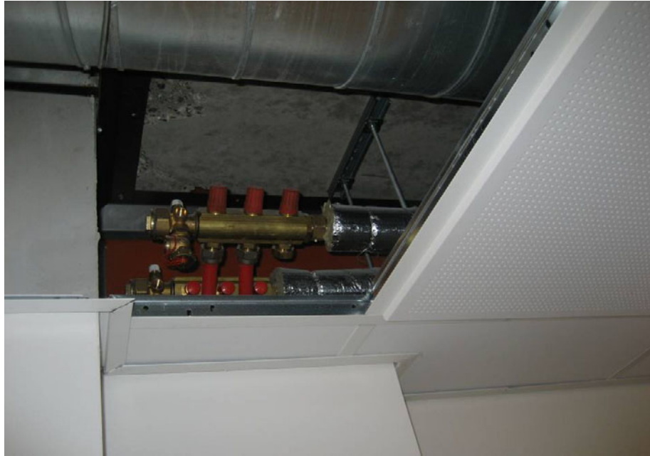
Figur 2.4.3. Uisolerede fordelerrør over loft.
