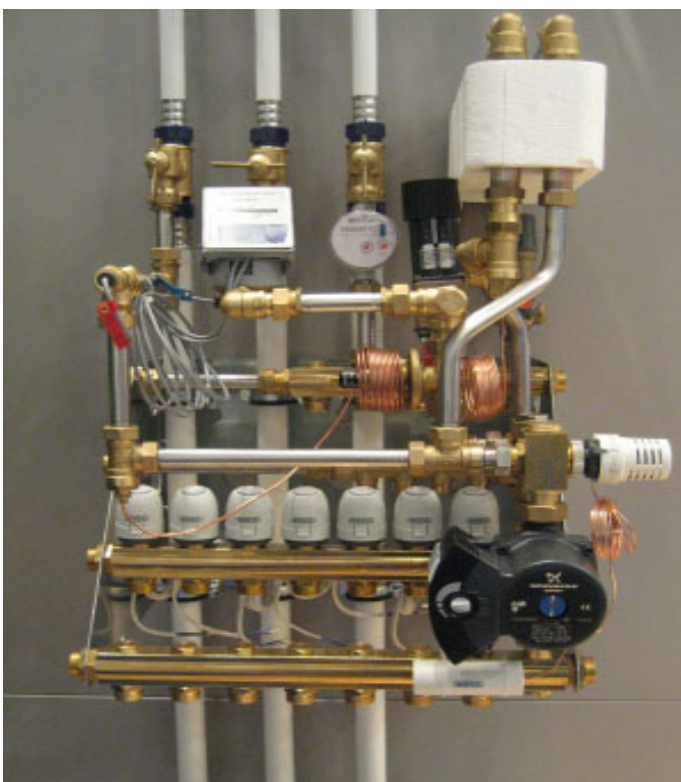
Figur 2.4.2. Unit med isoleret veksler, men med uisolerede fordelerrør.
