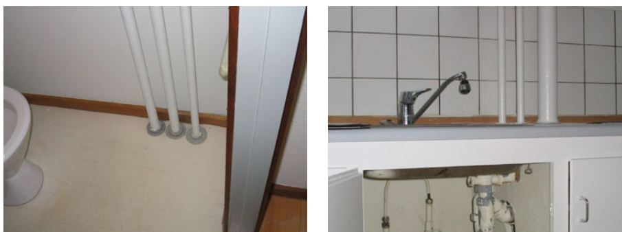
Figur 1.5.2. Uisolerede lodrette vandrør i toilet og køkken (ejendom fra midt 60-erne). (Foto: Fyns almennyttige Boligselskab).
