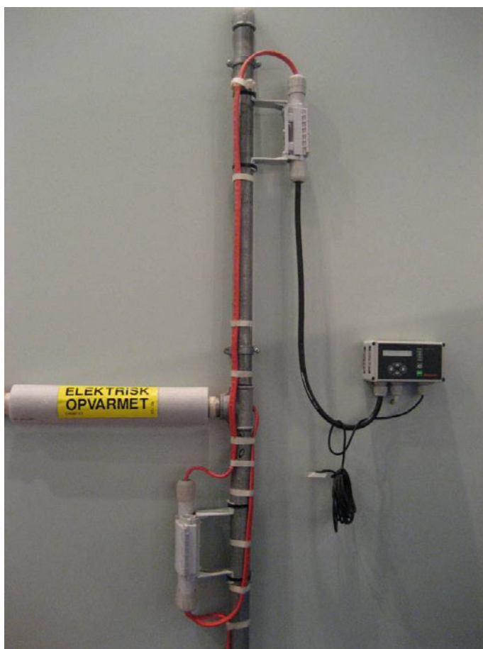
Figur 2.4.8. Varmekabel på vandrør, HWAT (rørisolering er kun vist delvis på det vandrette rør).
