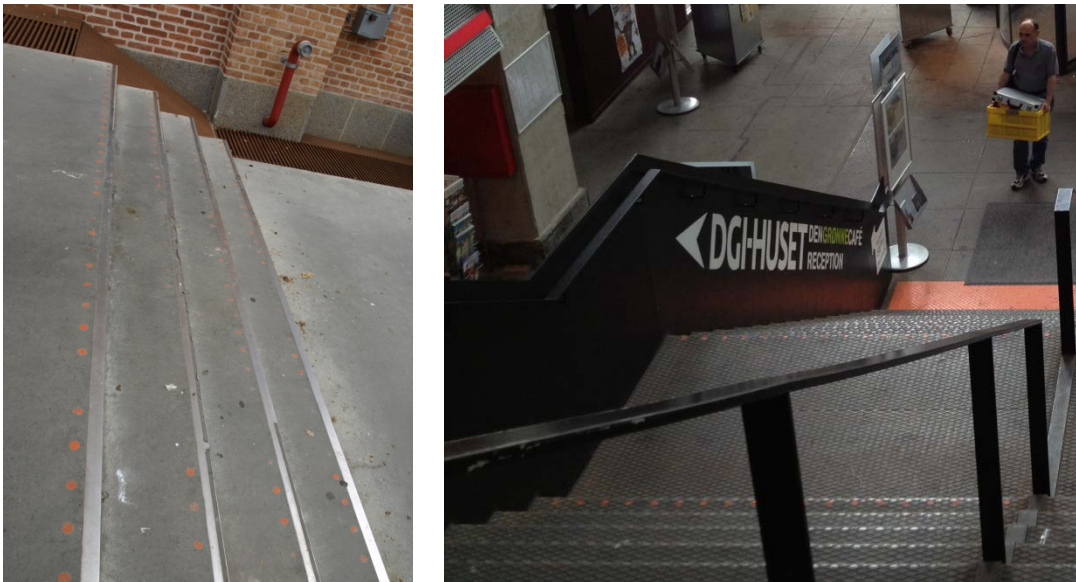
Illustration 4: Orange trinmarkering; venstre side: på udendørs trappe – højre side: på indvendig trappe, hvor man tillige ser gelænder/håndliste i fladjern.
