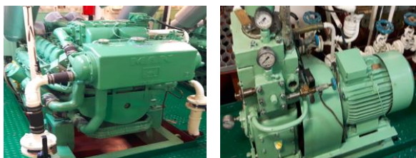
(d) diesel generator (e) pump load
