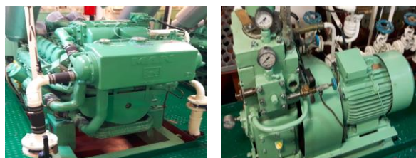
(d) diesel generator (e) pump load
