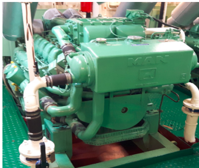
(d) Diesel generator
