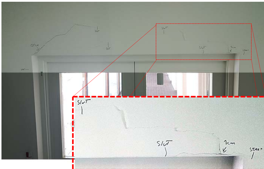
Figur 5. Nogle af de sætningsskader vi kiggede på ved gennemgangen af bygningerne.
