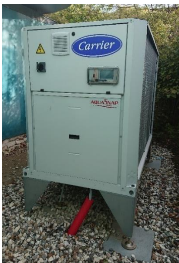
Figur 4. Varmepumpen placeret uden for svømmehallen.
