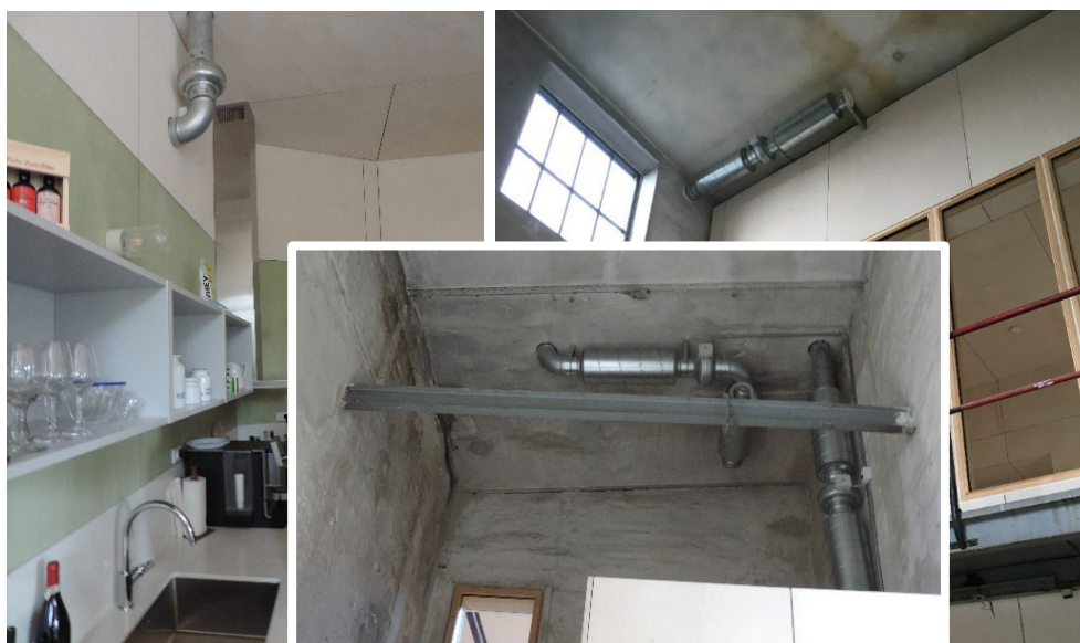
FIGUR 26. Ventilationen i køkkener og i de uopvarmede rum opleves store, klodsede og larmende. De er sidst i forsøgsprojektet suppleret med et balanceret varmegenvindingsanlæg, som kan afhjælpe problemer med afgang fra forurennet undergrund. Foto: Niels Haldor Bertelsen (2021).
