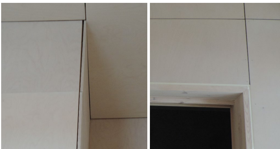
FIGUR 31. Fastgørelse af birkefinerpladerne svigter nogle steder, så mellemrummene gabes. Se eksempel på billedet til venstre. Der er anvendt plastisk fugemasse mellem dørkarm og birkefinerpladerne, hvilket ikke passer sammen med de øvrige fuger mellem birkefinerpladerne, som er åbne. Se eksempel på billedet til højre. Foto: Niels Haldor Bertelsen (2021).
