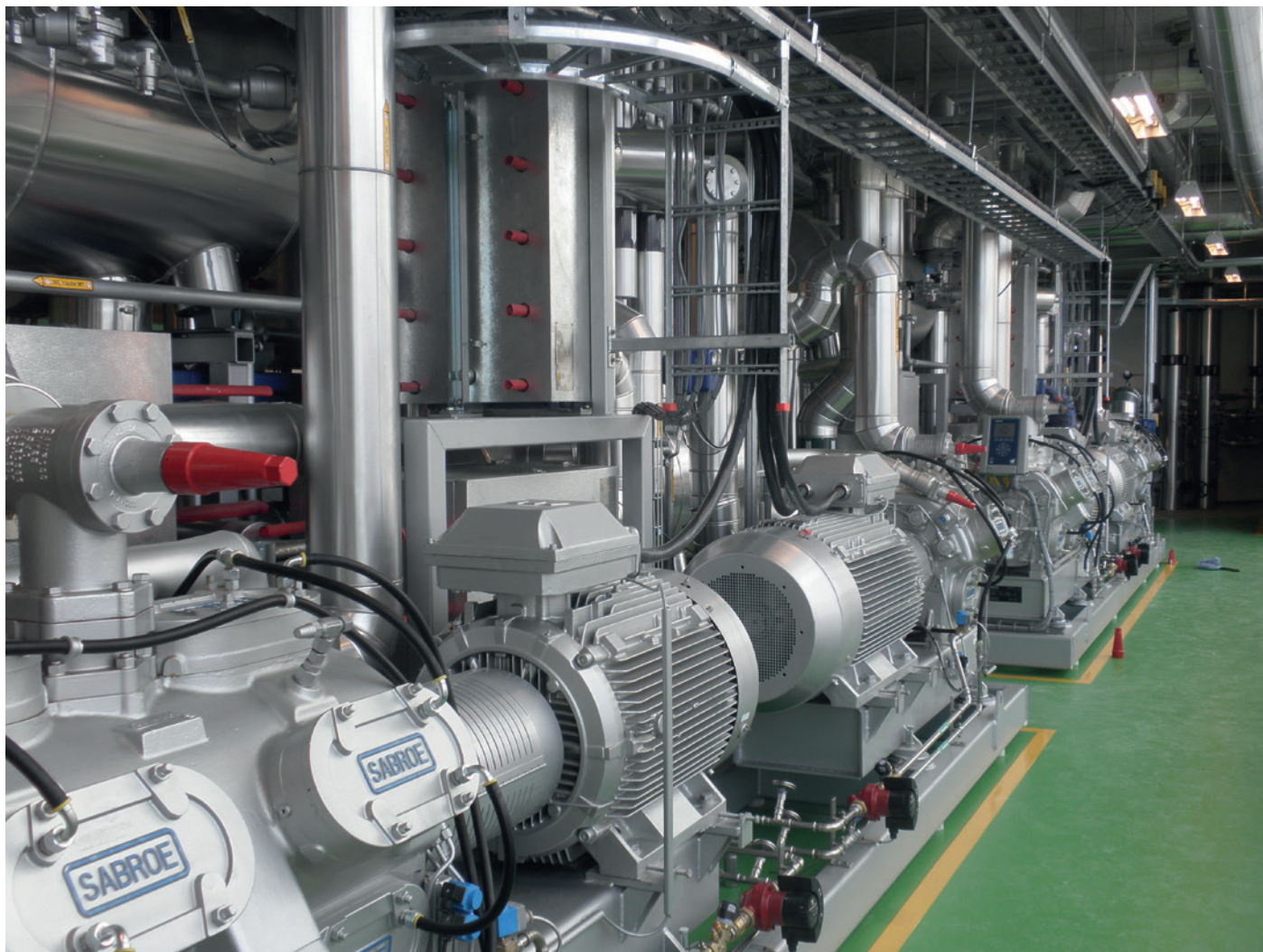
Foto 2. Kølevand fra datacentre kan i stigende grad udnyttes på de danske fjernvarmeverker, efter at der her med varmepumper sker en temperaturforøgelse.
