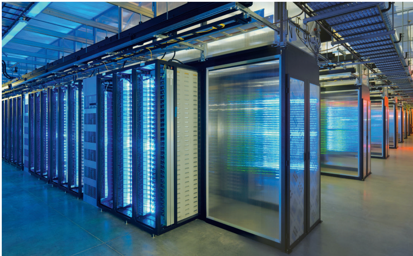
Foto 1. De store amerikanske datacentre, der etableres i Danmark, har et meget stort elforbrug i døgnet 24 timer til henholdsvis drift og køling af centrene mange servere.
